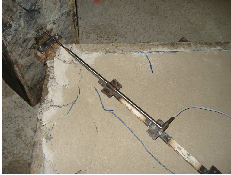
Şekil 4.30. Dördüncü deneysel çalışmaya ait hasar seviyesi
