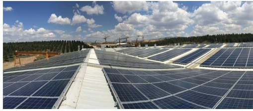
Şekil 4.19. Bina çatısında bulunan fotovoltaik paneller
