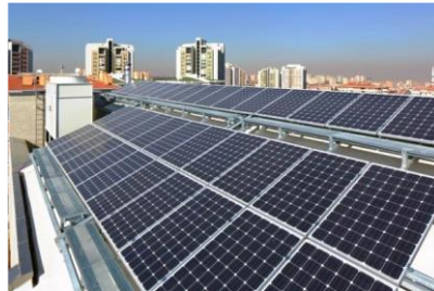
Şekil 4.47. Çatıda bulunan güneş paneli
