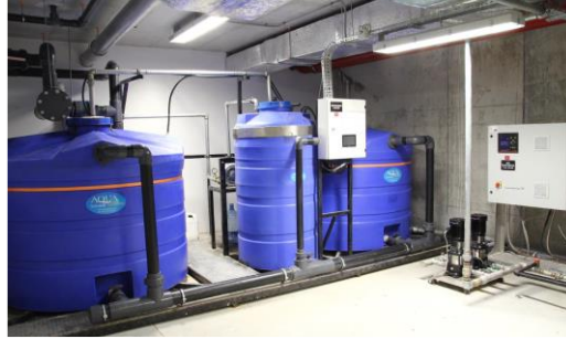
Şekil 4.17. Paket tip gri su arıtma sistemi
