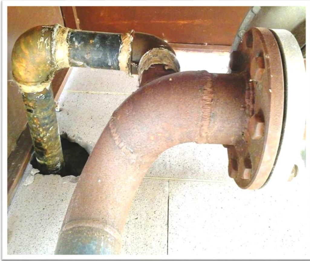
Şekil 4.45. Sayaç öncesinden ilave hat alınarak kaçak gaz kullanımı,
