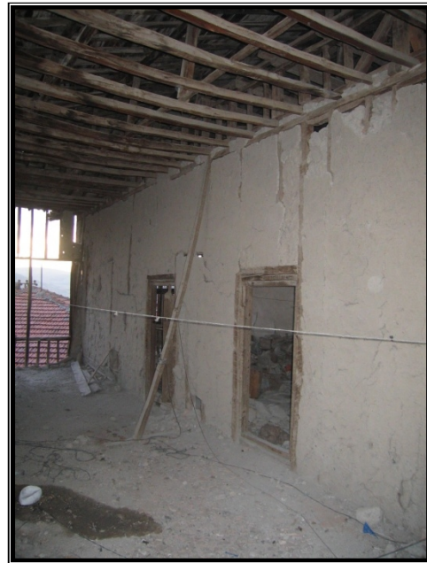
Resim 4.135 Duvarlarda kayıp malzeme
