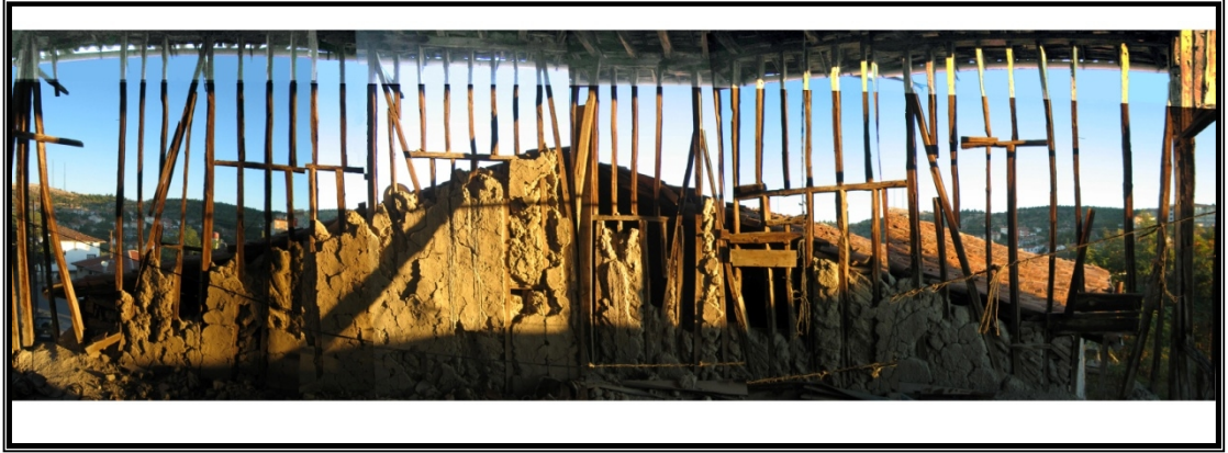
Resim 4.43 104-105 Oda dış duvarın tehlike içeren ahşap çatkısı
