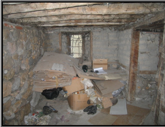
Resim 4.59 B02 Depo görünüşü 2
