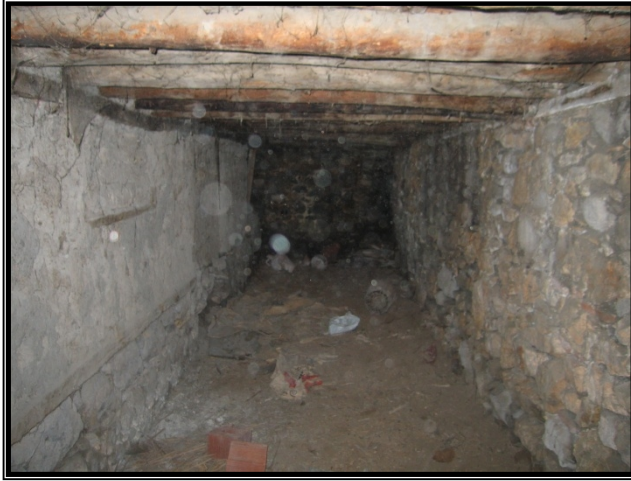
Resim 4.58 B02 Depo görünüşü 1
