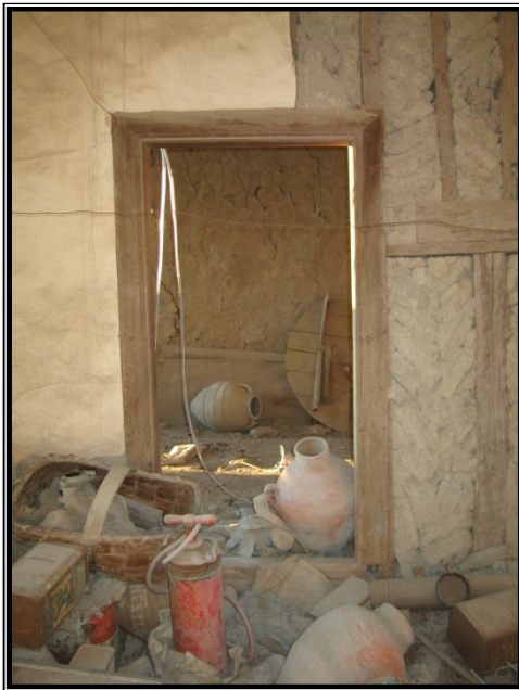
Resim 4.134 Kapılarda kayıp malzeme
