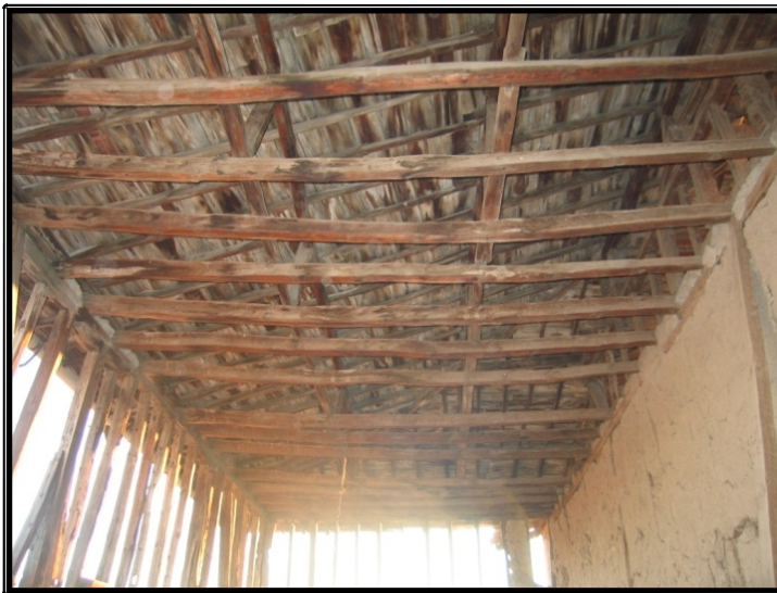
Resim 4.133 Döşeme kirişlerindeki sehim
