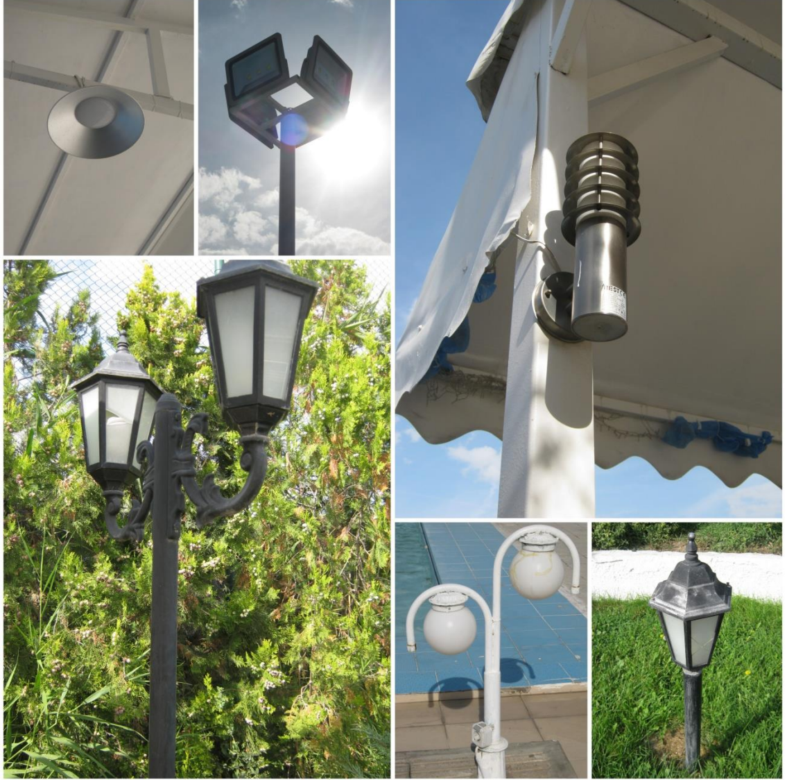
Şekil 4.64. Alan içerisinde bulunan çeşitli aydınlatma elemanları
