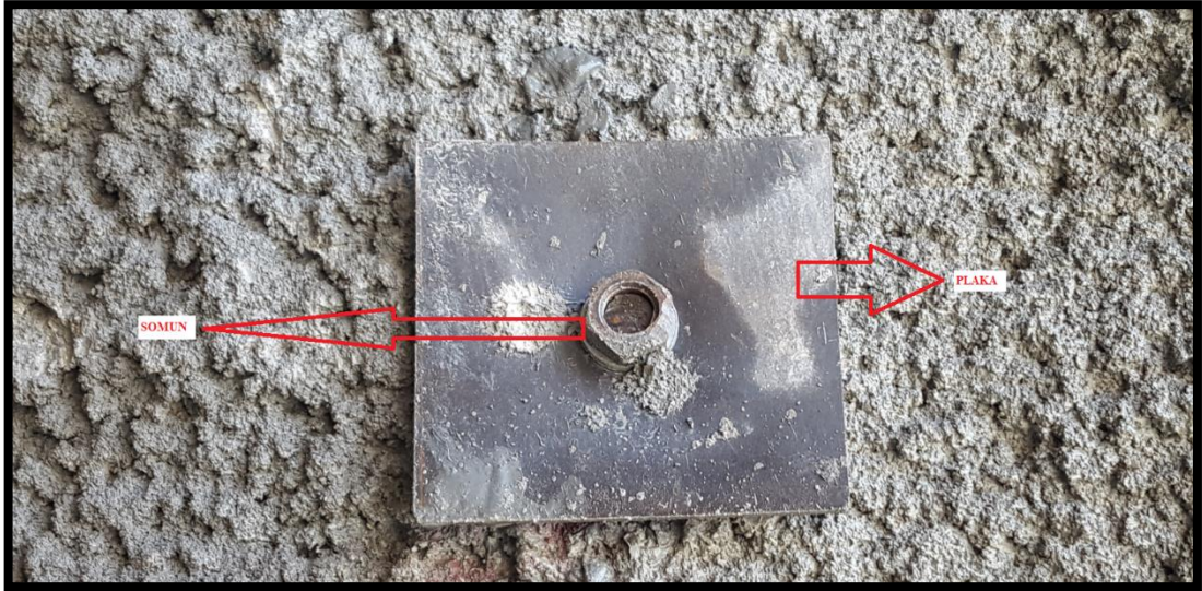
řekil 4.34. İnceleme alanında tařıma plakası ve somun yerleřimi
