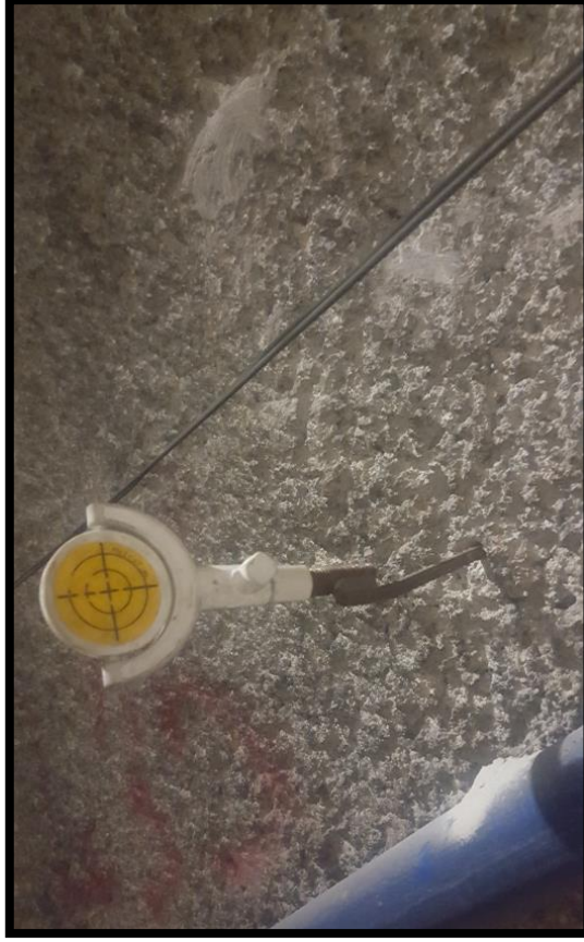
Şekil 4.10. İnceleme alanında tünel kesitindeki deformasyon ölçüm reflektörü
