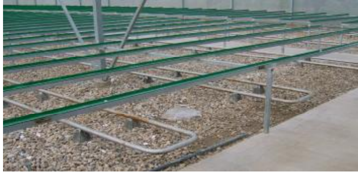
Şekil 4.10. Merkezi Isıtma Sisteminin Uygulandığı Bir Sera İşletmesi
