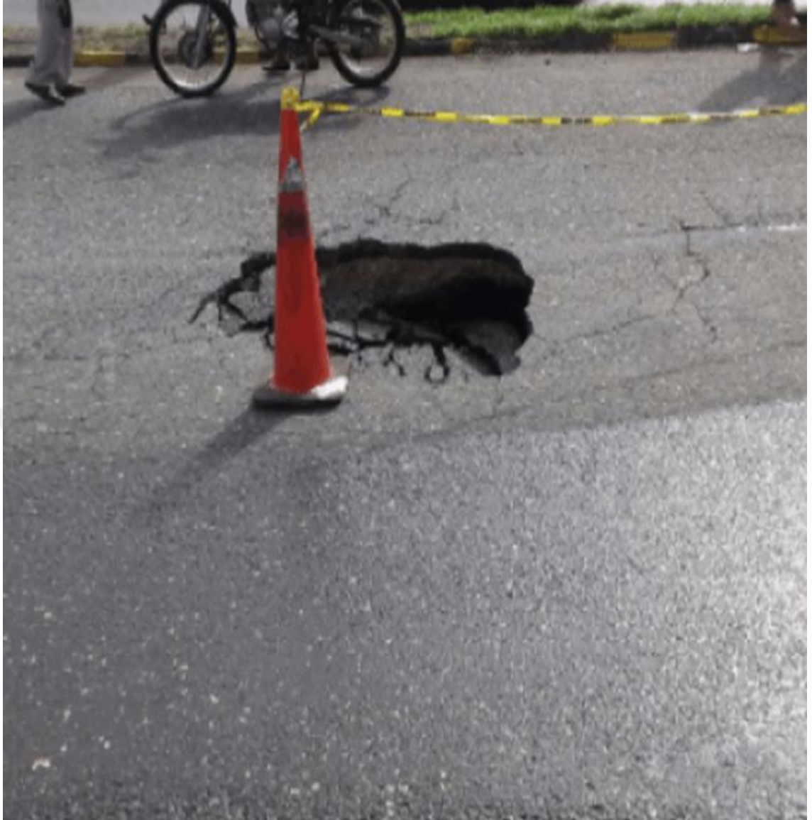
Şekil 2.13. Yerel Çökme ve Ötelenme (Shoving)
