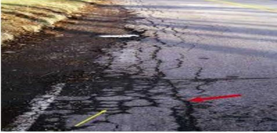
Şekil 2.6. Kenar Çatlağı ( https://insapedia.com/asfalt-yollarda-meydana-gelen-kusur-ve-hasar-cesitleri/ )
