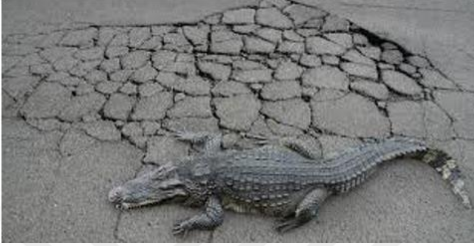
Şekil 2.5. Timsah Sırtı Görünümlü Çatlaklar ( https://insapedia.com/asfalt-yollarda-meydana-gelen-kusur-ve-hasar-cesitleri/ )
