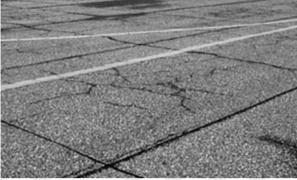
Şekil 2.8. Yansıma Çatlakları ( https://www.movea.com.tr/asfalt-bozulmalari-neden-olusur/ )
