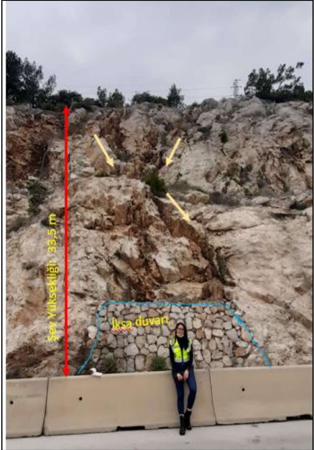
Şekil 4.21. A7- Sınıfı şevde iksa duvarı ve eklem çatlakları görünümü
