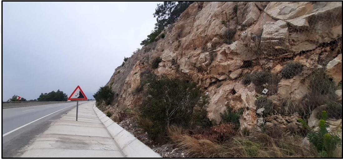
Şekil 4.4. Bölgedeki kaya düşmelerine duyarlı olduğunu gösteren uyarı levhası
