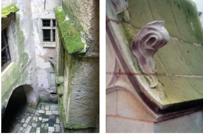
Şekil 24. Bina yüzeyinde alg oluşum örnekleri (ICOMOS, 2008).
