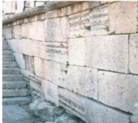
Şekil 16. Üç Şerefeli Camii, beden duvarlarını oluşturan taşların tabakalaşma yönünde dikkat edilmeden yerleştirilmesi duvar yüzeyindeki bozunmalara sebeptir (Küçükkaya, 2019).
