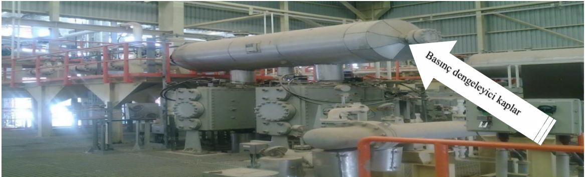
Şekil 30. API 618 Kobelco kompresöründe basınç dengeleyici kaplar (Kobelco, 2006).
