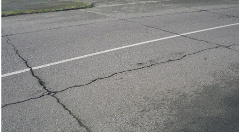
Şekil 10. Kaplamada oluşan yansıma çatlakları [61]
