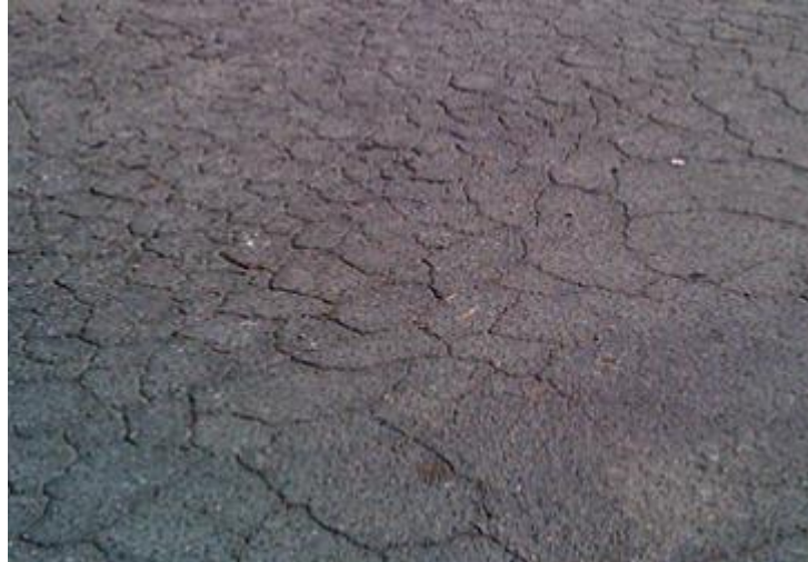
Şekil 11. Kaplamada oluşan timsah sırtı çatlakları [61]
