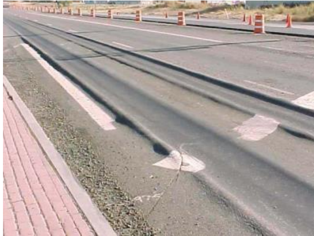
Şekil 3. Kaplamada oluşan tekerlek izi [56]
