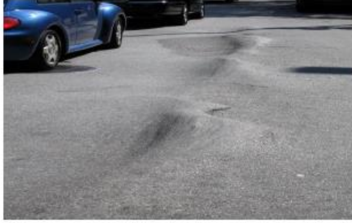
Şekil 8. Kaplamada oluşan ondülasyon [60]
