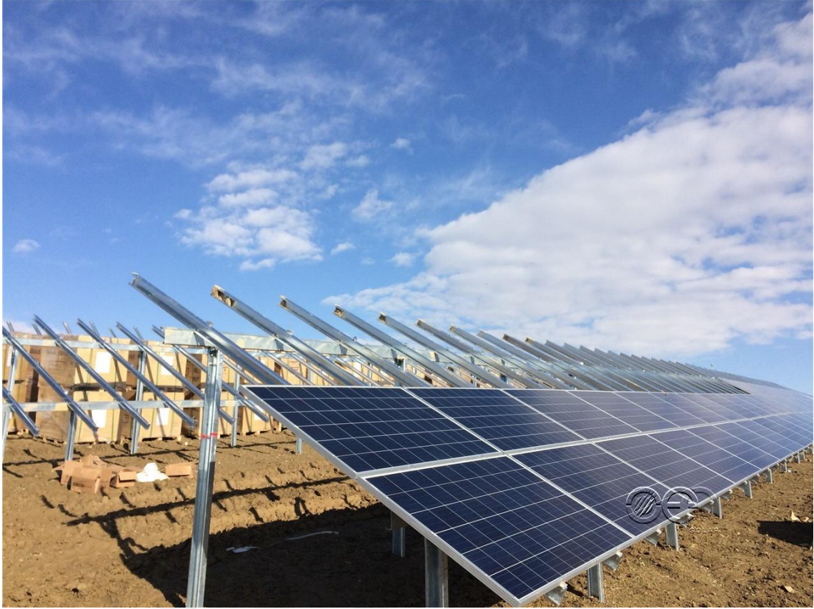
Şekil 3.4. Hafif çelik güneş enerji santrali (Akzemin Mühendislik A.Ş., 2020)
