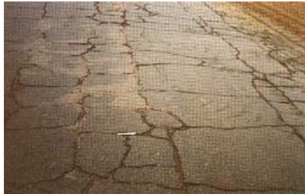
Şekil 4.4 Blok çatlak tipi bozulma.
