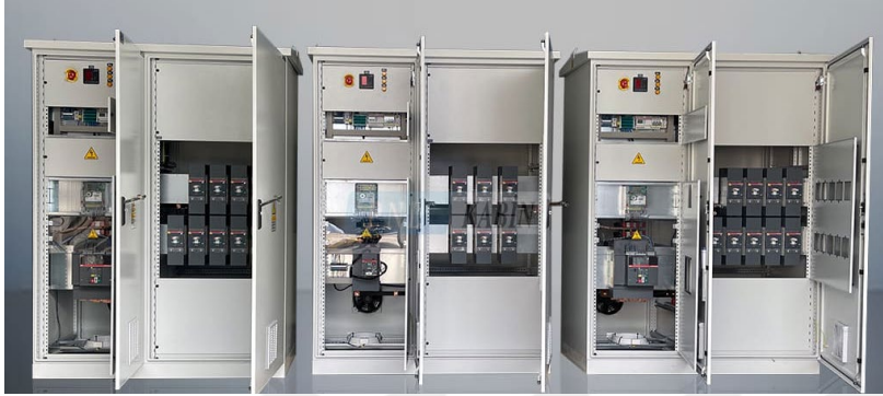
Şekil 2.7. GES toplama panosu
