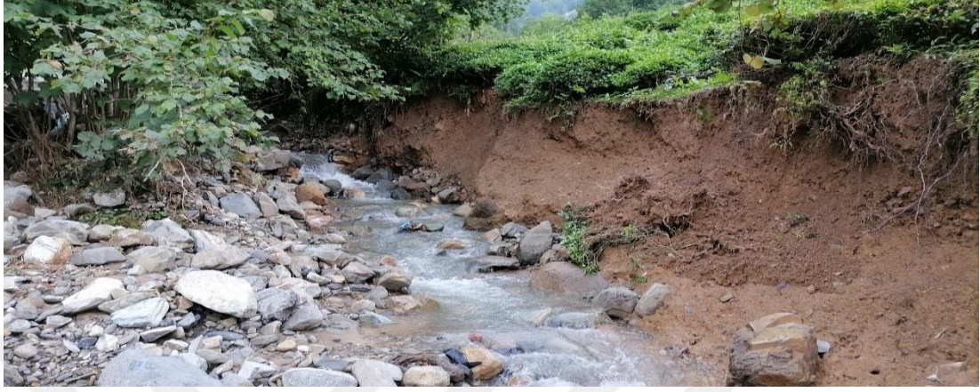
Şekil 7. Arhavi Üç Pınar Bölgesinde Kanal/Şev Erozyonu
