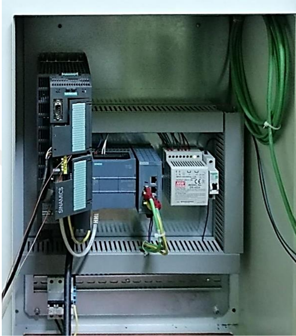
Şekil 3.20. Motor kontrol panosunun iç tasarımı
