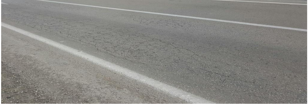
Şekil 1.24. Timsah sırtı (yorulma) çatlak.
