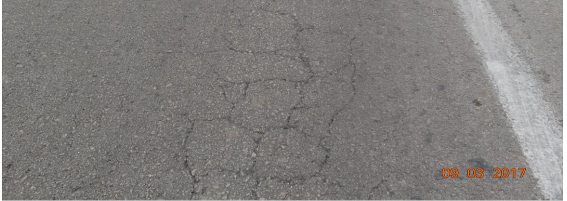
Şekil 1.28. Blok (Harita) çatlak.
