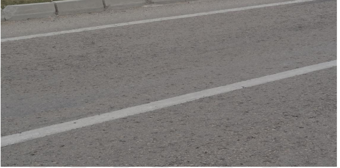
řekil 1.34. Segregasyon, soyulma, sklme.
