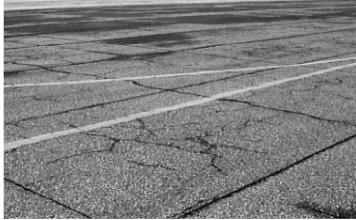
Şekil 10. Yansıma çatlağı (Karakaş, 2014)
