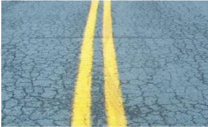
Şekil 6. Yorulma çatlağı (URL-3, 2023)
