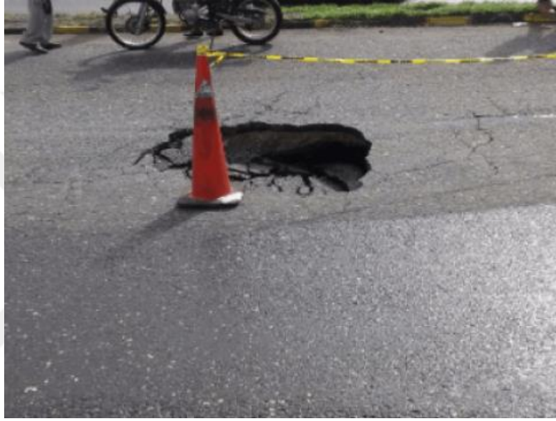
Şekil 5. Kaplamada çökme deformasyonu (URL-2, 2023)
