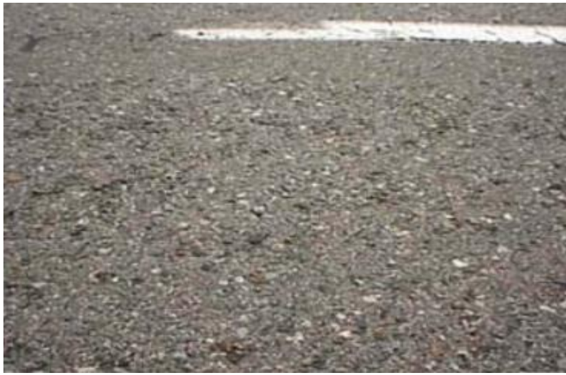
Şekil 15. Asfalt kaplamasındaki sökölme (Yılmaz, 2016)
