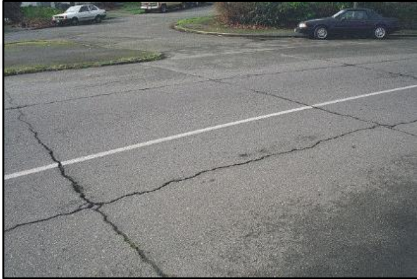
Şekil 9. Yansıma Çatlağı (URL-7., 2024).
