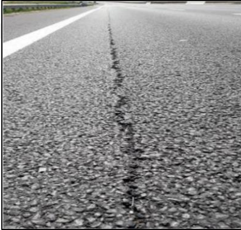
Şekil 7. Termal Çatlaklar (Canestrari & Ingrassia, 2020).
