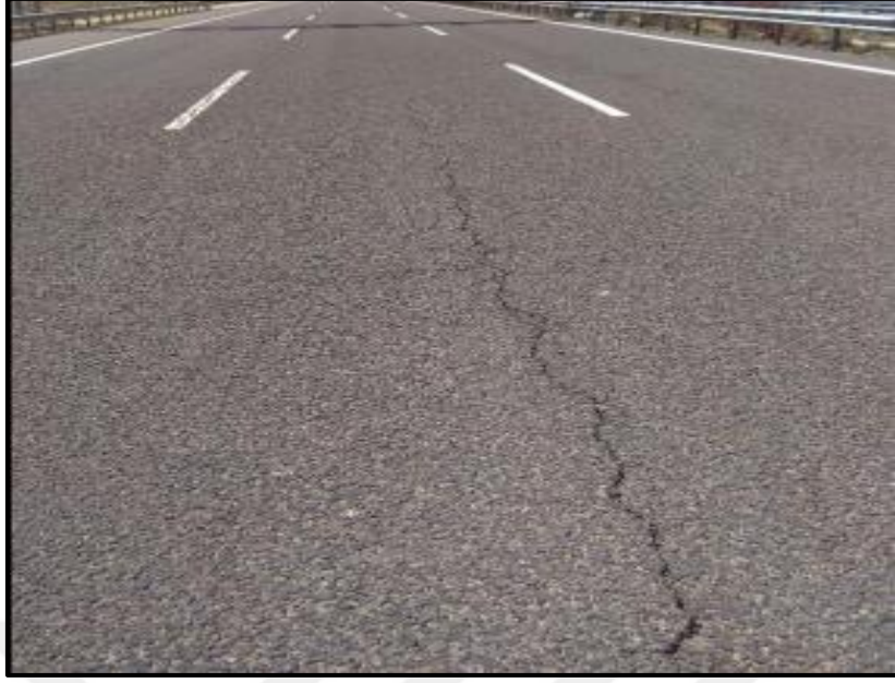
Şekil 8. Ek Yeri Çatlağı (KGM, 2023).
