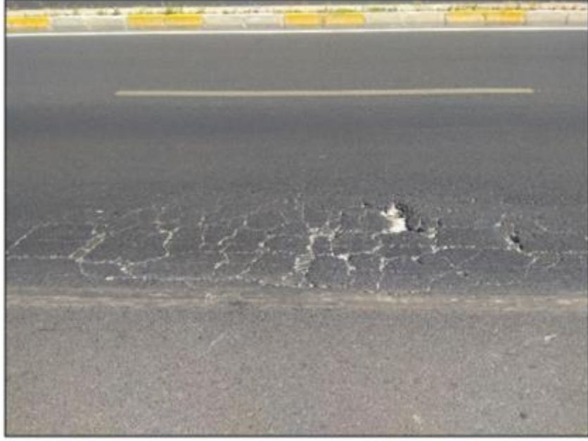
Şekil 1. Yorulma Çatlağı (KGM, 2023).
