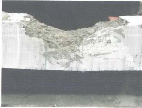
Ek-C21. L11.15c kirişinin göçmesi
