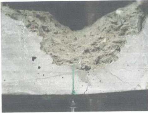
Ek-C1. S5.7a kirişinin göçmesi
