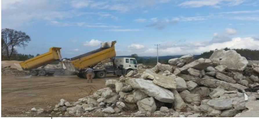
Şekil 2. İnşaat Atıkları Depolama Alanı (URL-3, 2023)
