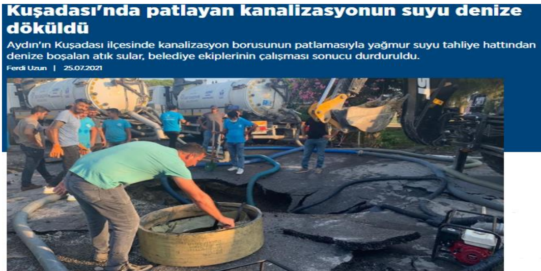
Şekil 3.12. Atık su hattında meydana gelen sorun (URL-8).
