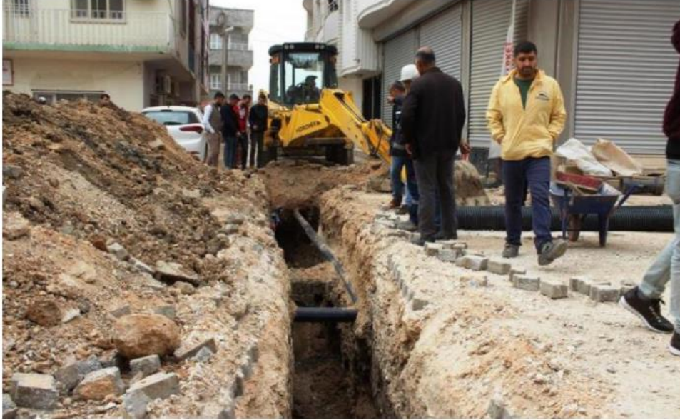
Şekil 3.10. Altyapı çalışmaları esnasında elektrik hatlarının kopması (URL-5).
