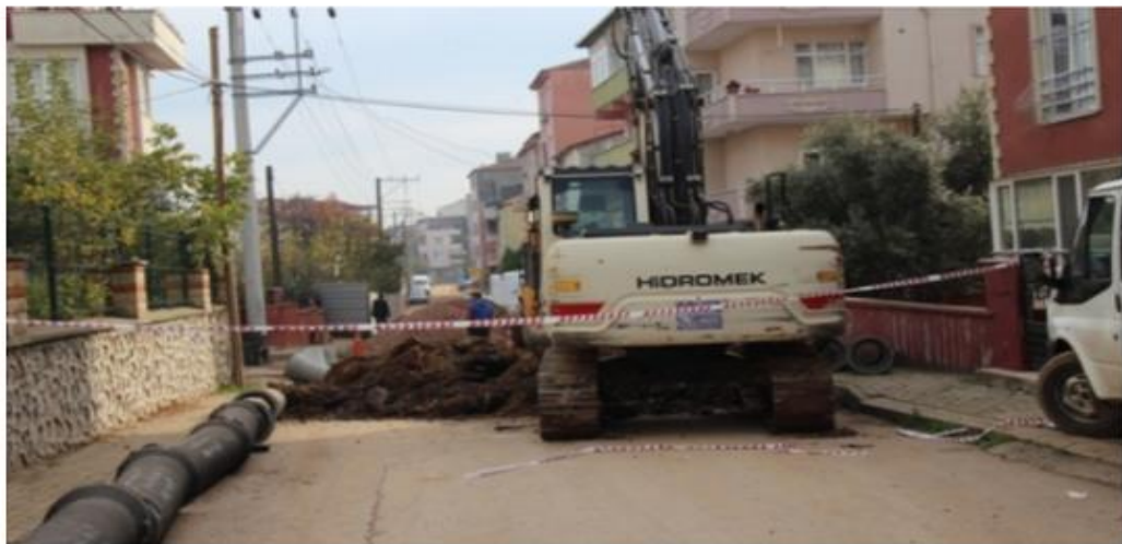
Şekil 3.11. Yeraltındaki doğalgaz hattında patlama (URL-6).
