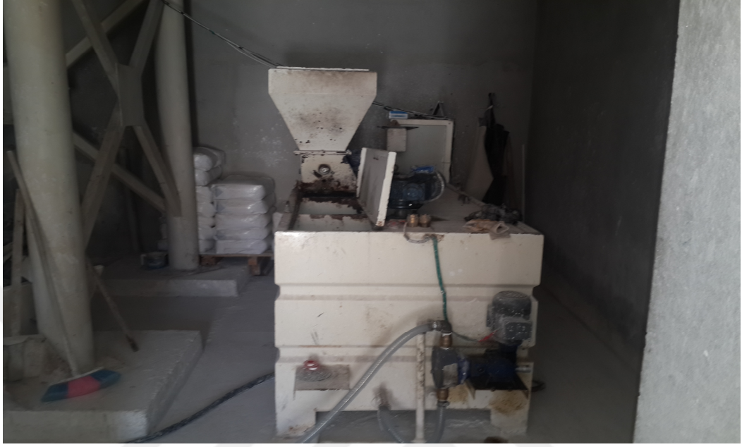
Şekil 2.3. Arıtma çamuru şartlandırma ünitesi
