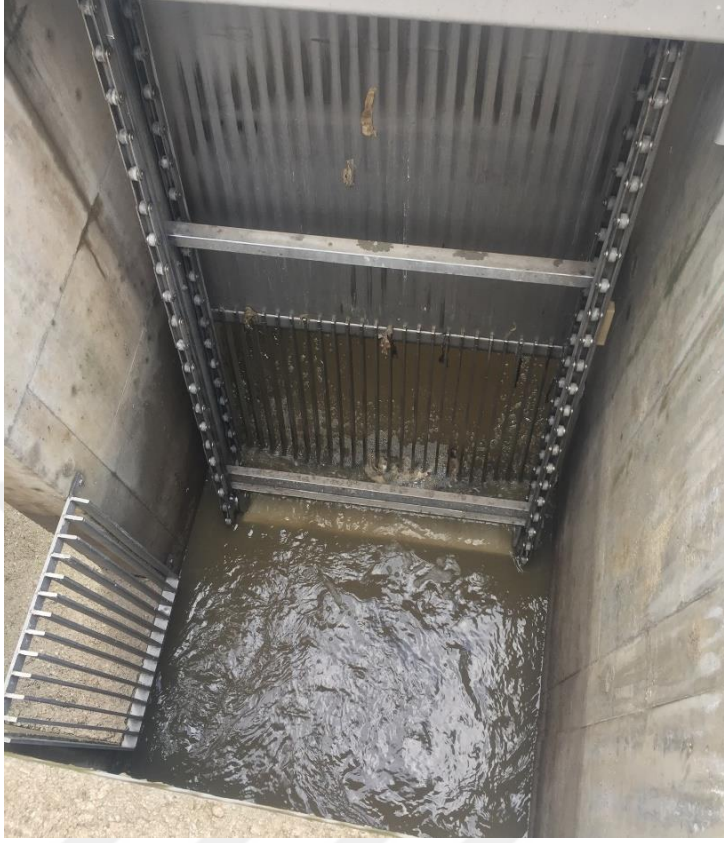
Şekil 15. Gümüşhane Atık Su Arıtma Tesisi ızgaraları
