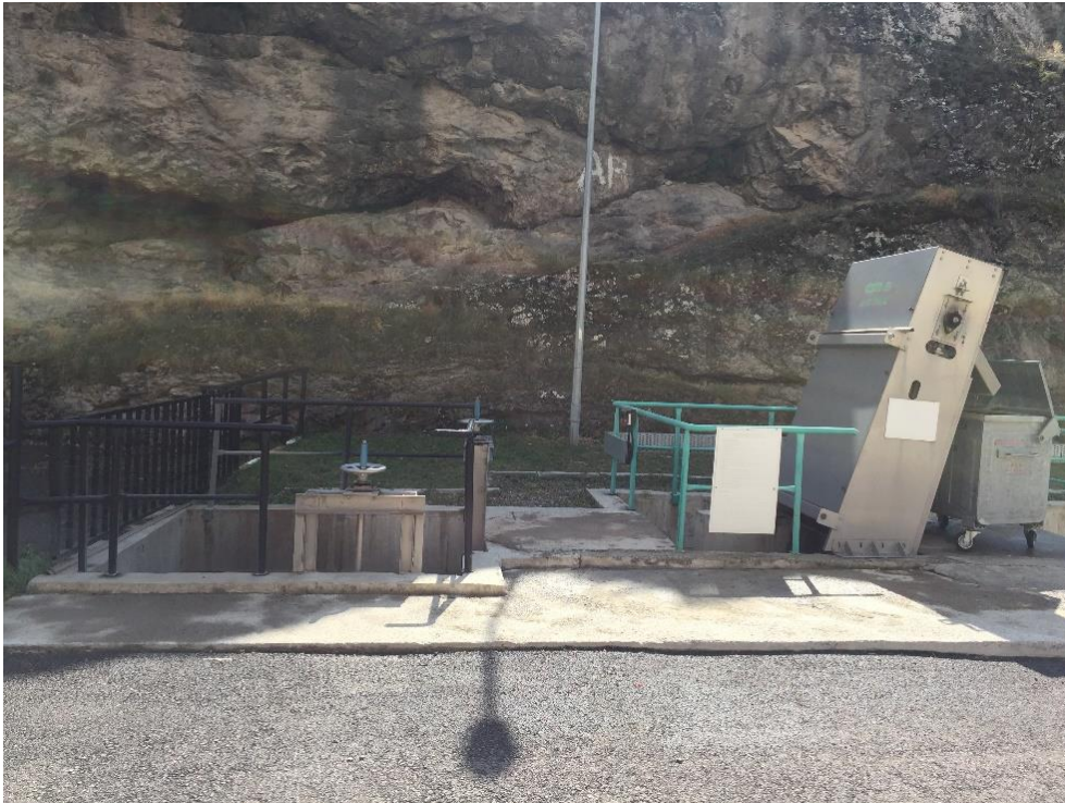
Şekil 14. Gümüşhane Atık Su Arıtma Tesisi yükleme havuzu, yaklaşım kanalı ve ızgaralar
