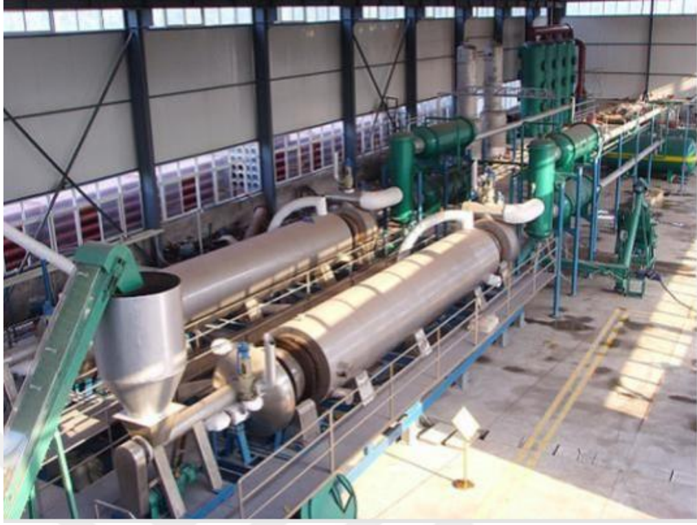
Şekil 6.6: Piroliz tesisi (Yakaboylu, 2011).
