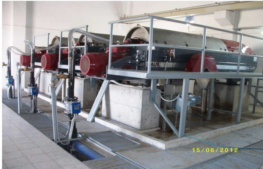
Şekil 8.5: Çamur susuzlaştırma ünitesi.
