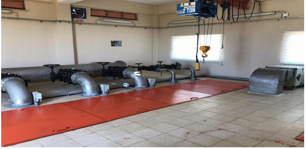
Resim3. 26 Geri Devir Ünitesi Pompa ve Boru Hatları
