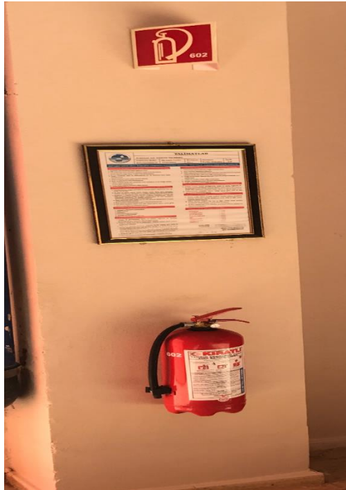
Resim3. 27 Yangın Söndürme Tüpleri
