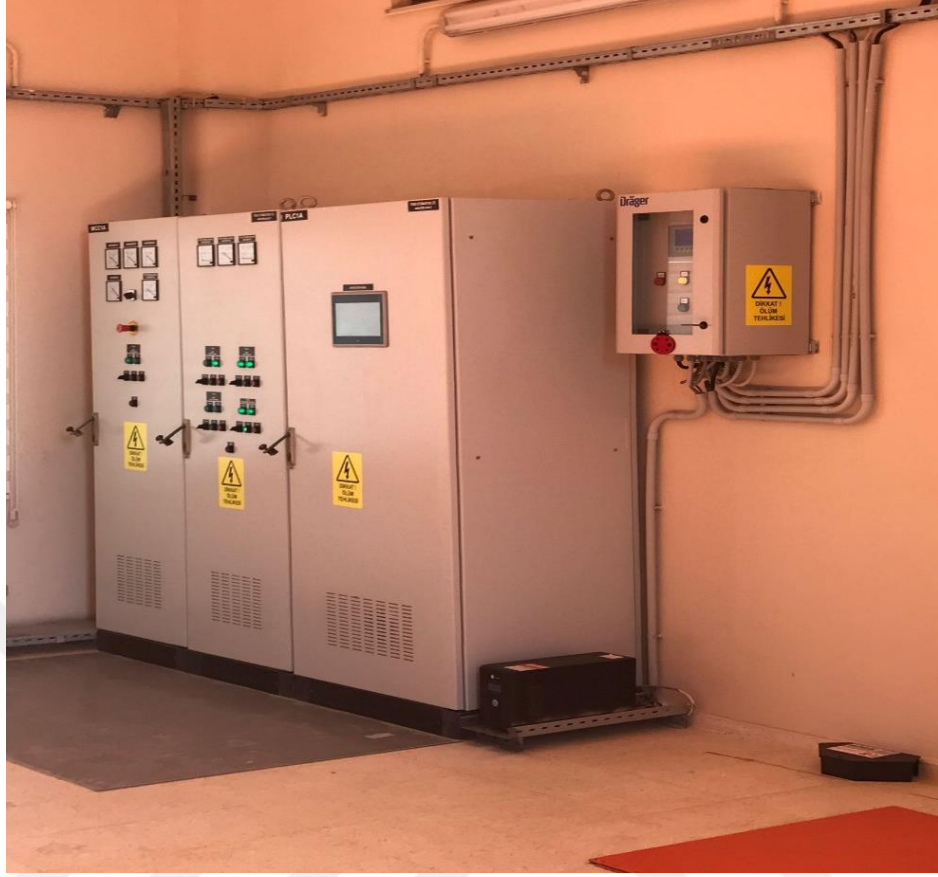
Resim3. 5 Giriş Terfi Ünitesi Otomasyon Panosu
