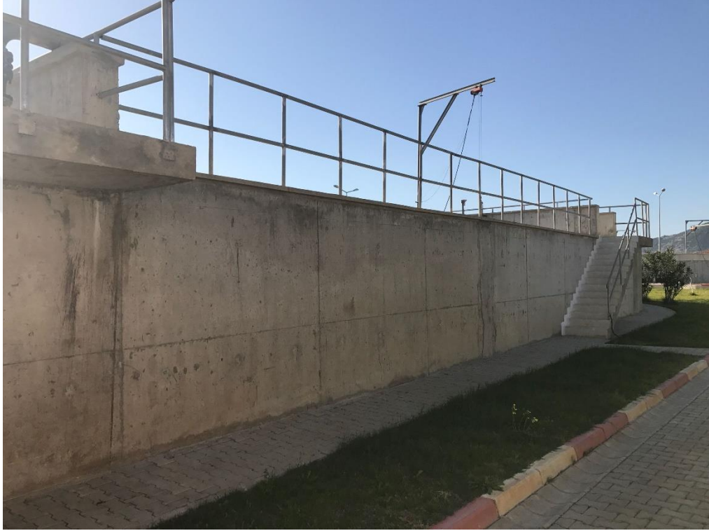
Resim3. 8 Havalandırma Havuzu Ünitesi
