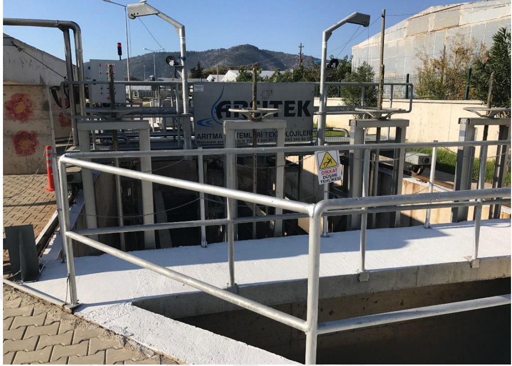
Resim3. 6 Havalandırılmalı Kum ve Yağ Tutucu Ünitesi
