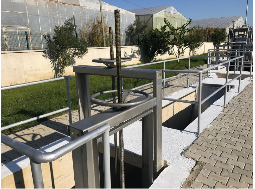
Resim3. 1 Kaba Izgara Ünitesi
