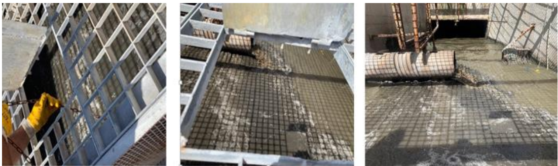
Şekil 3.13. Tatlar Atıksu Arıtma Tesisi girişı (MP4).
