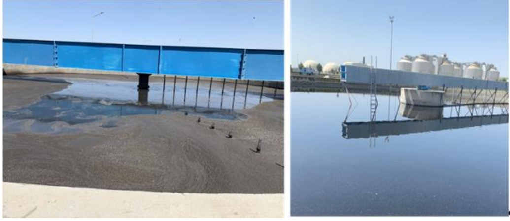
Şekil 3.17. Ön çökeltim havuzları.
