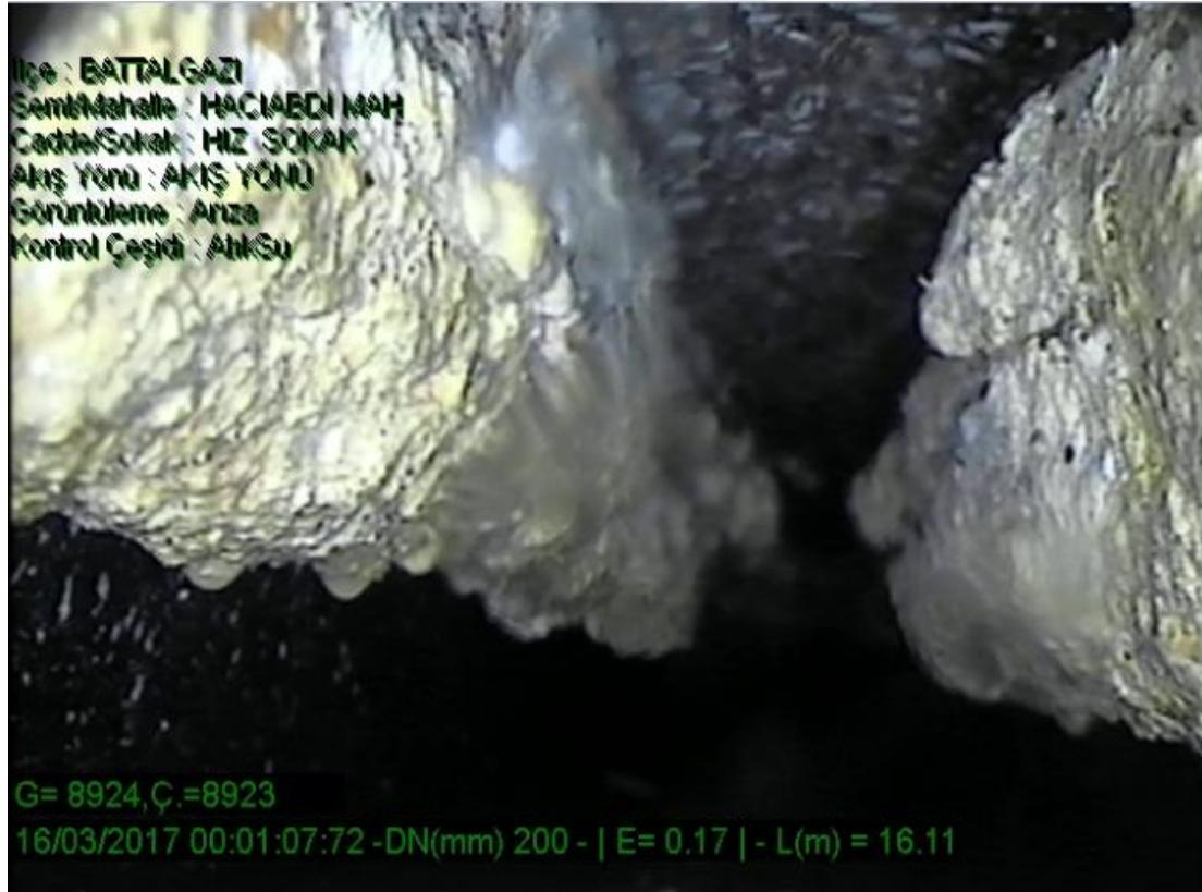
Şekil 4.5. Yapısal Kusurlar, Yağ ve Gres (MASKİ, 2018)
