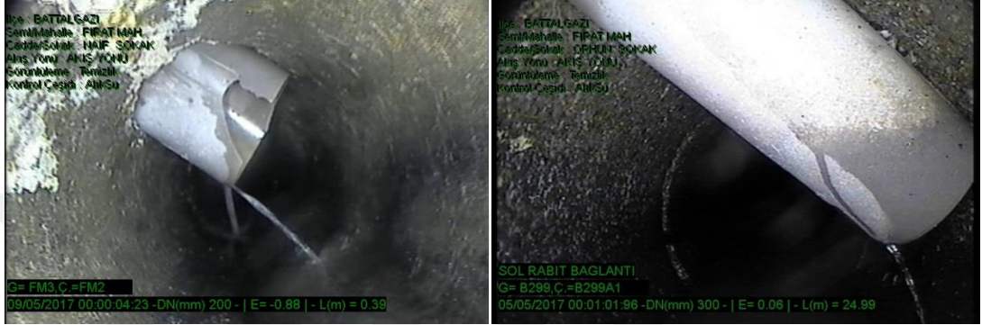
Şekil 4.13. Yapısal Kusurlar, Bina Bağlantı Yanlış İmalatı (MASKİ, 2018)
