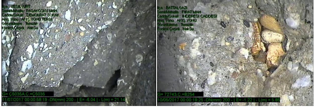
Şekil 4.8. Yapısal Kusurlar, Bozulma/Deformasyon (MASKİ, 2018)
