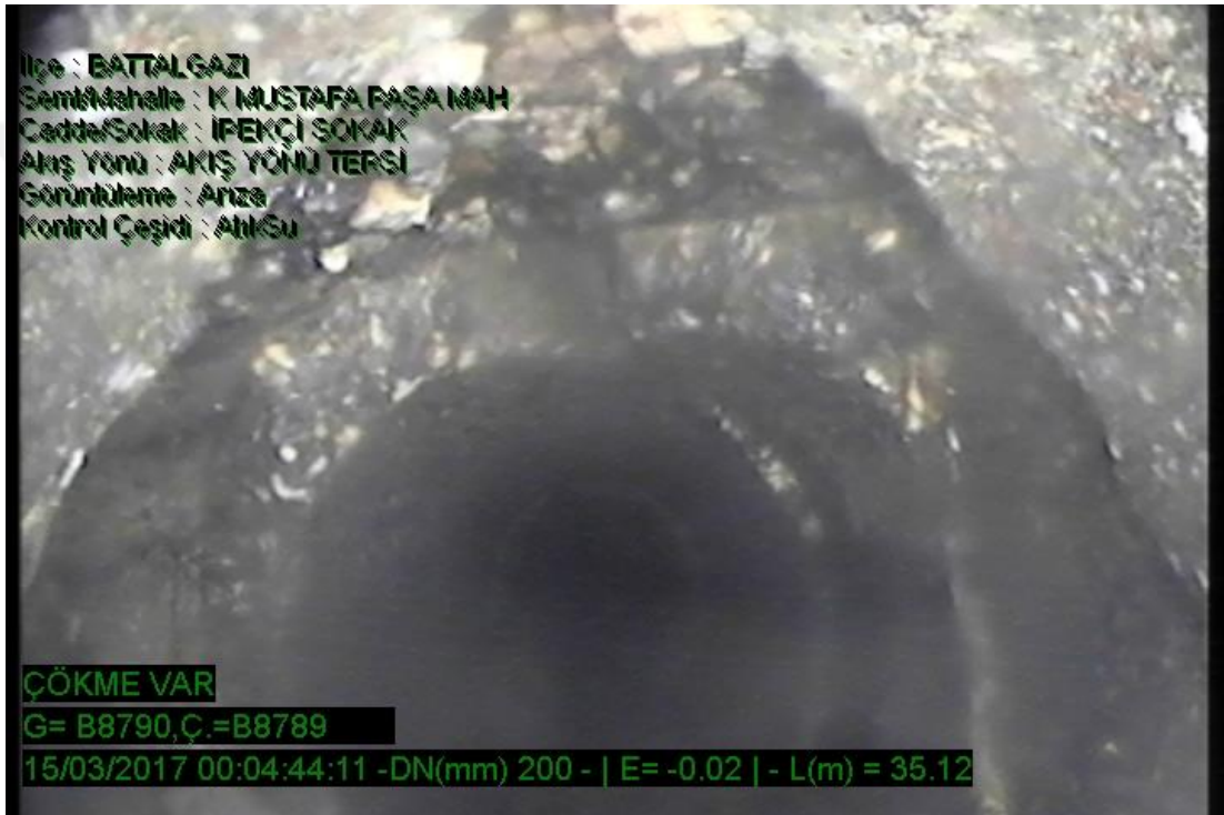
Şekil 4.7. Yapısal Kusurlar, Çökme (MASKİ, 2018)
