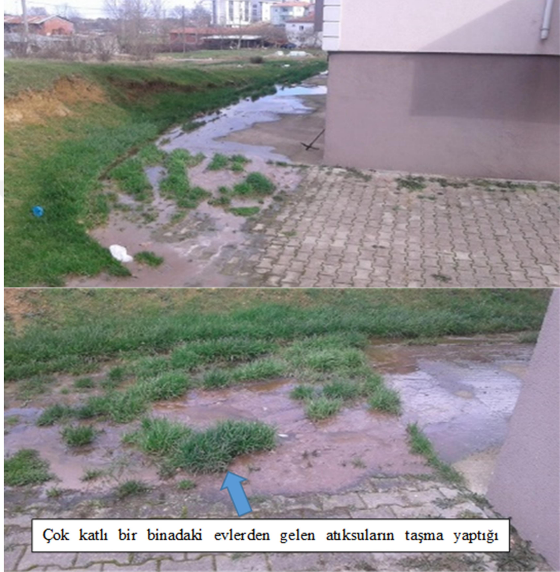
řekil 4.6. Binaların pıssu giderlerine yeteri kadar eęim verilmemesi durumunda meydana gelen tıkanma problemlerine rnekler.
