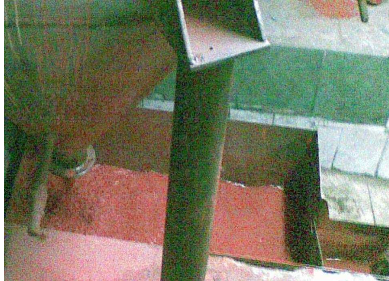
Şekil 3.15 Toz çöktürme ünitesi
