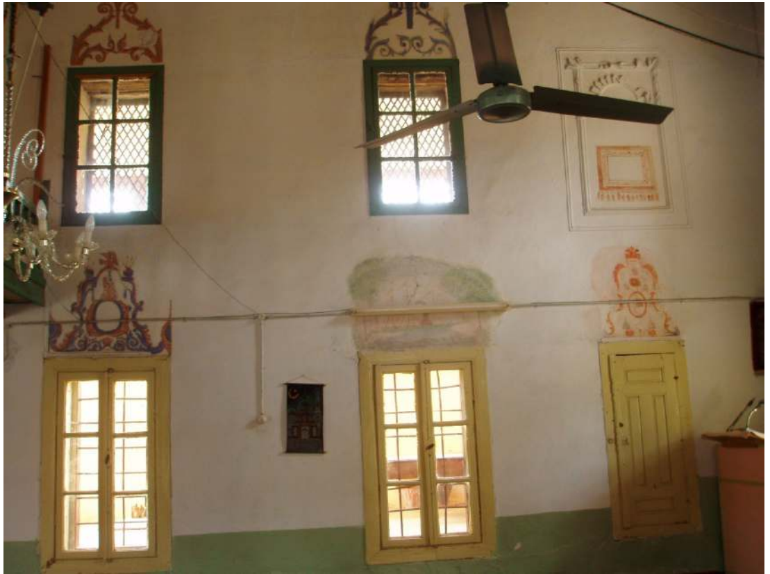
Fotoğraf – 200 – Koçarlı Cincin Köyü Cihanoğlu Camii Doğu Duvarı
