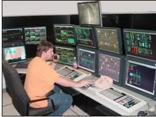
Şekil 8.1 Merkezi kontrol odası.
