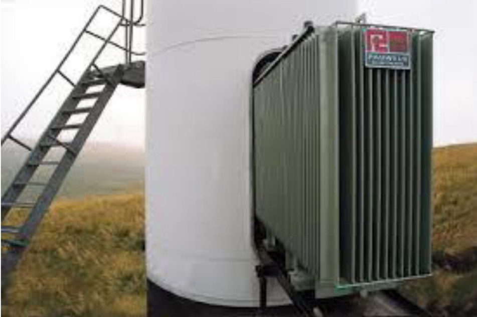
Resim 2.15. Rüzgar türbini uygulamaları
