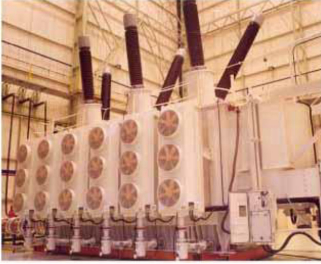
Resim 2.20. Geçiş köprü transformatörü
