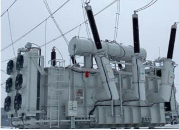
Resim 2.3. Trafo merkezi transformatörleri
