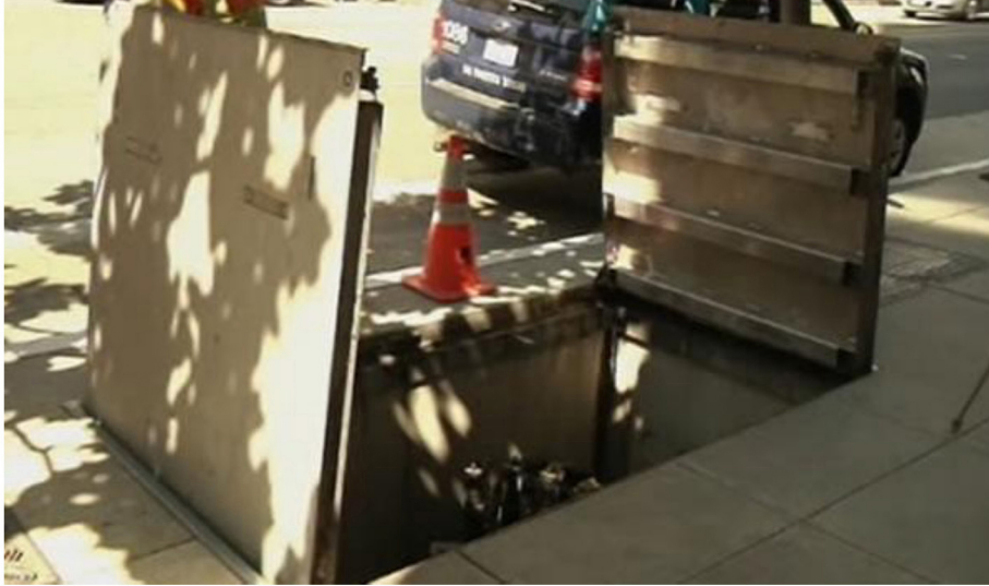
Resim 2.17. Yer altı transformatörü
