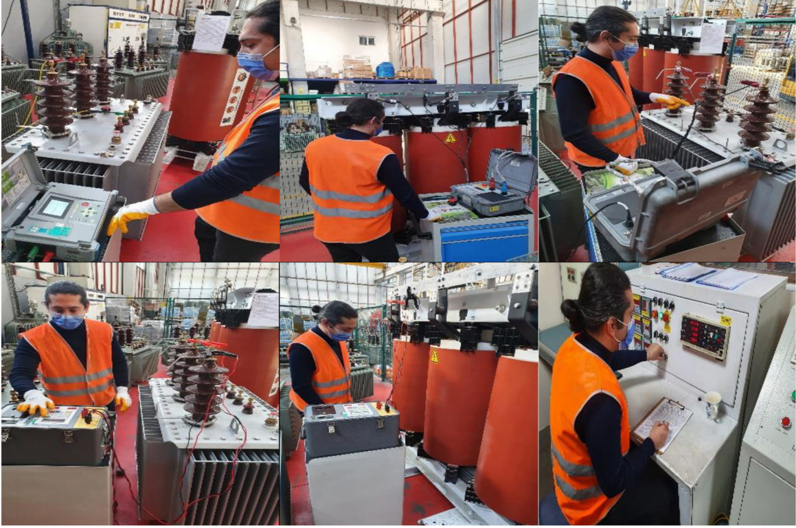
Resim 4.1. (devam) Tek transformatör akredite labratuvarında rutin testlerin yapılması
