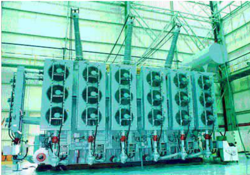
Resim 2.19. Jeneratör yükseltici transformatörü
