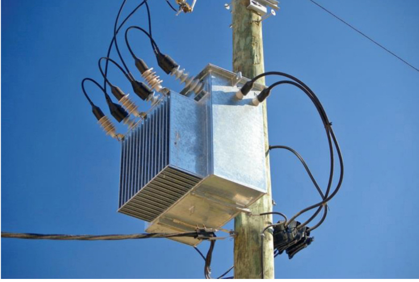
Resim 2.11. Direk tipi transformatörler
