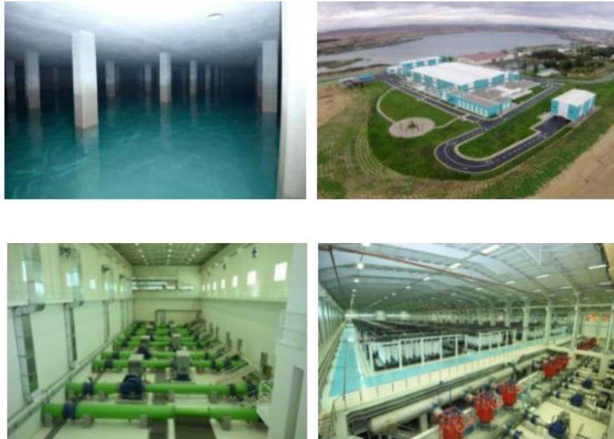
Şekil 3.13. Ceyranbatan ultrafiltrasyon su arıtma tesisleri
