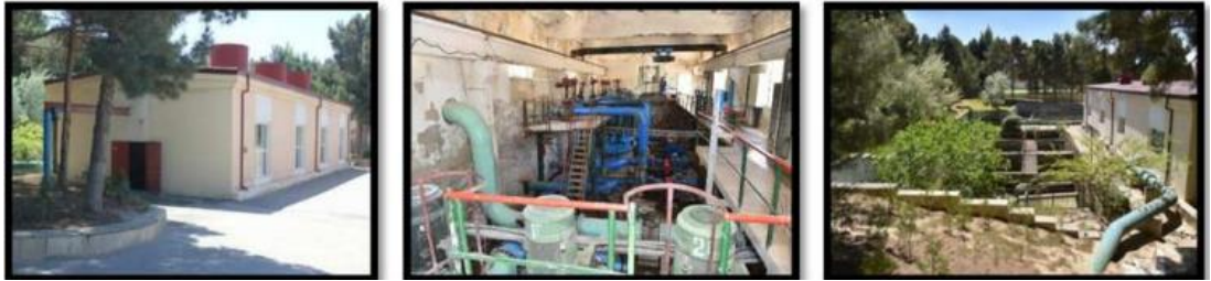
Şekil 3.11. Atık su pompa istasyonu
