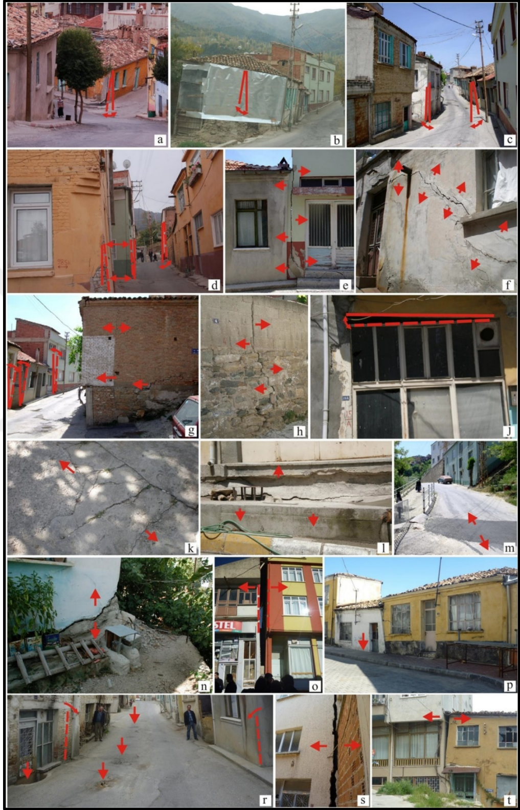
Şekil 85: Gündoğdu Mahallesi'nde, yapı ve yollarda yamaç hareketi nedeniyle gelişen olumsuzluklara örnekler (Çelik, 2012:5).
