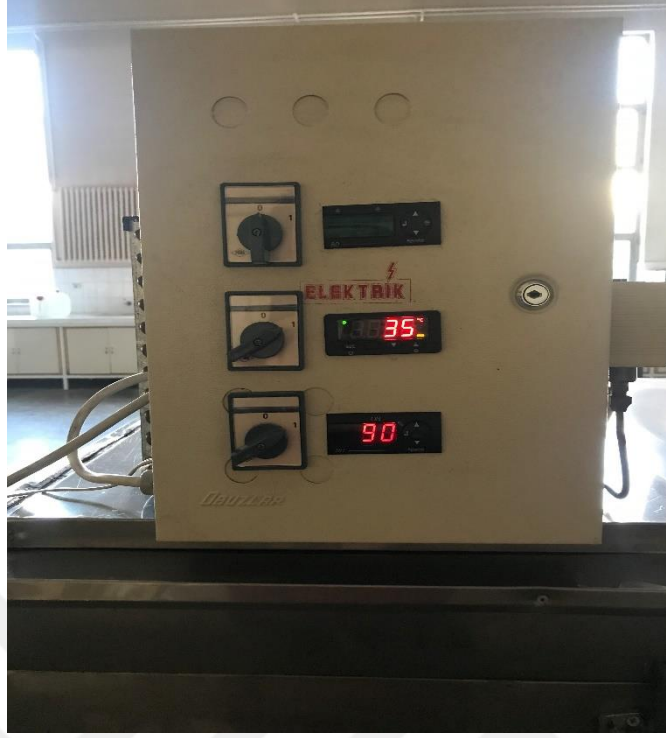
Şekil 3.11. Sıcaklık ve % bağıl nem kontrol paneli (genel görünüm)
