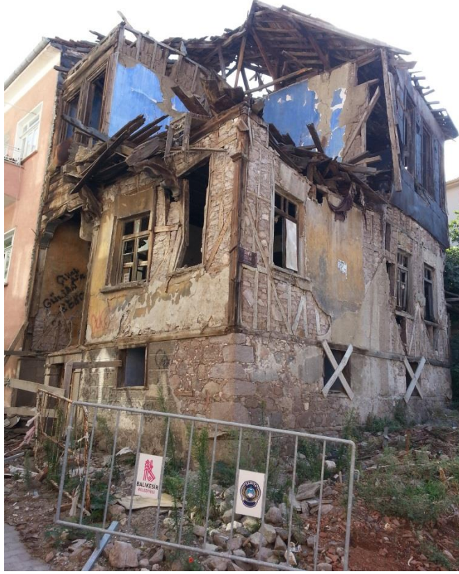
Şekil 3.23 Yangın sebebiyle ağır hasar alan bir yapı 14 ada, 5 parsel
