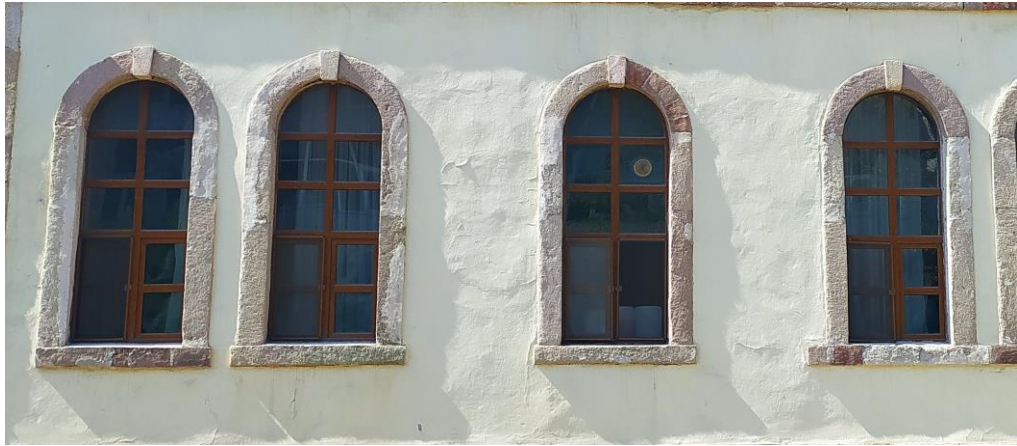
Resim 3.5.8. Pencerelerin taş sövelerinde oluşmuş olan bozulmalar, 2022
