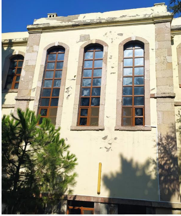
Resim 3.5.13. Yapının güney cephesinde yer alan dökülmeler, 2022
