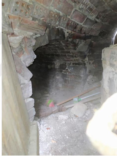
Resim 3.5.6. Giriş merdiven altında yer alan ve deforme edilen havalandırma kanalı girişi, 2022
