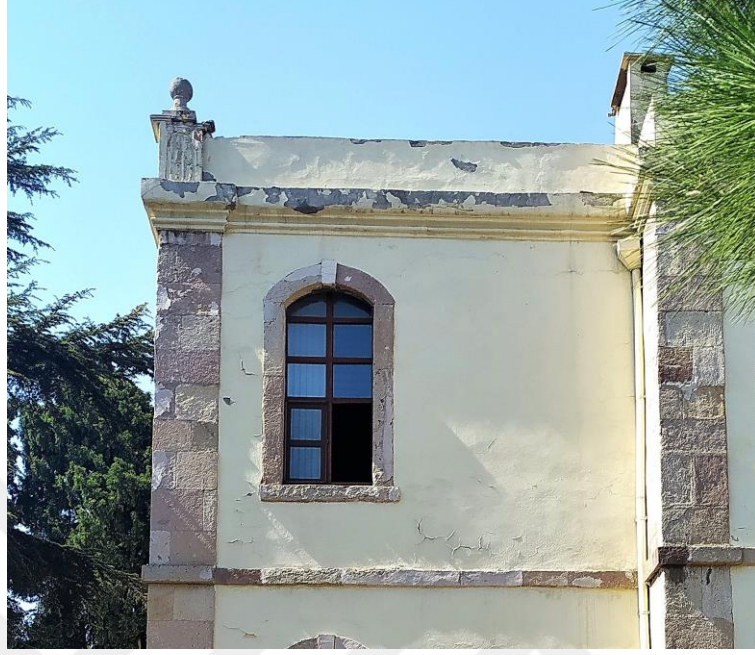
Resim 3.5.11. Çatı süslemeleri, saçak silmesi ve pilasterlerdeki bozulmalar, 2022
