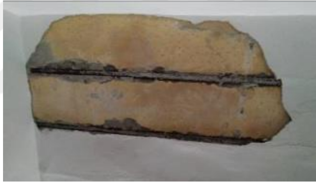
Resim 3.4.50. Sıvası dökülmüş olan döşeme görseli, 2022
