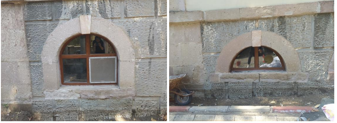
Resim 3.5.9. Bodrum kat pencere sövelerinde oluşmuş olan dökülmeler, 2022
