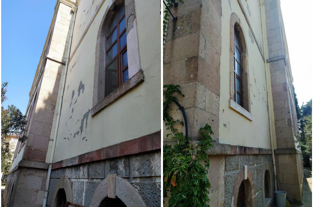
Resim 3.5.14. Yapının batı cephesindeki bozulmalar, 2022
