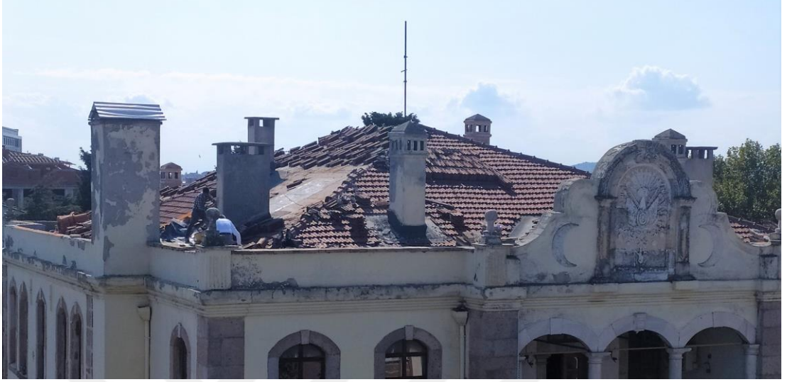
Resim 3.5.15. Üçgen alnlıkta yer alan dökülmeler, 2022
