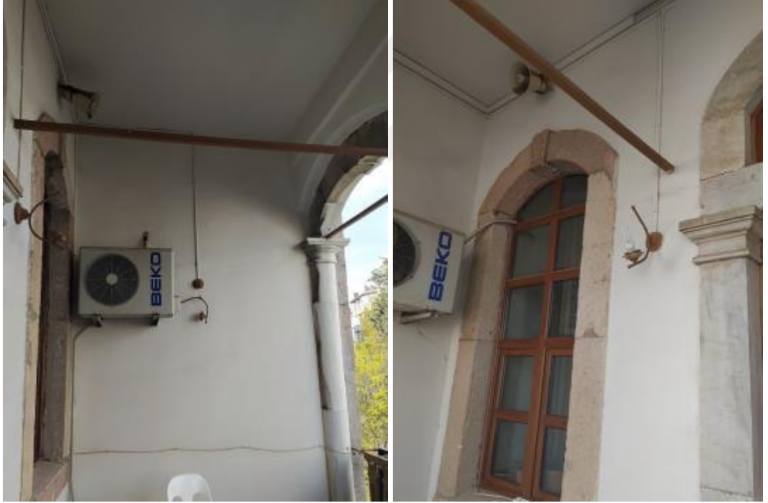
Resim 3.5.10. Balkonda yer alan klima santralleri, 2022
