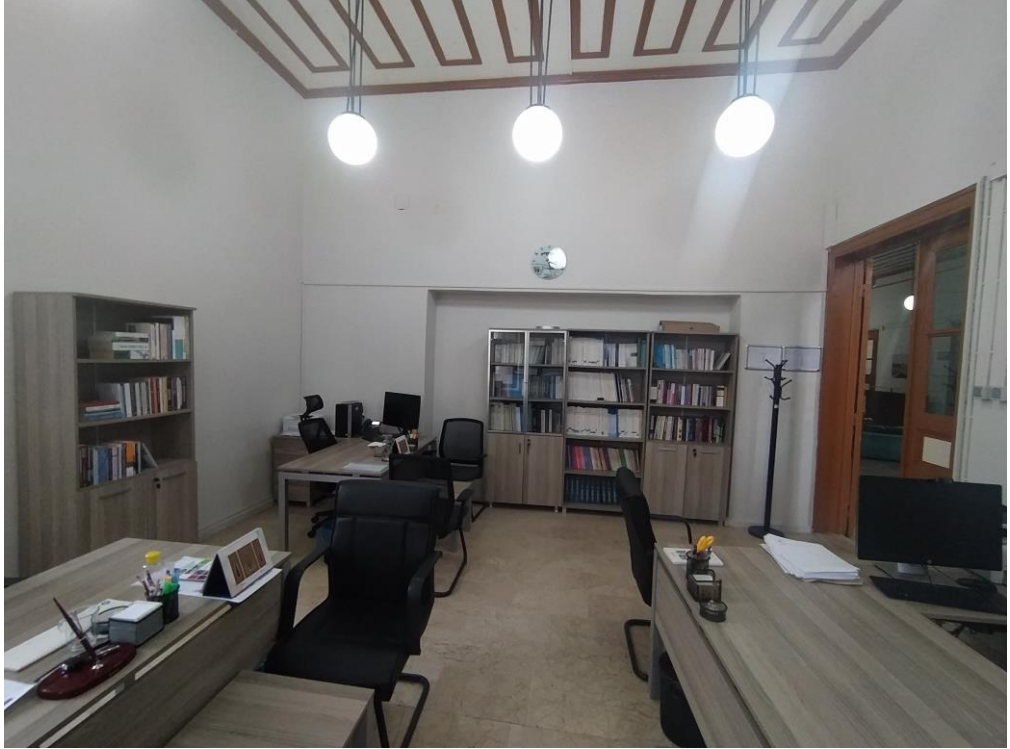
Resim 3.5.3. Z07 ve Z08 mekanları arasındaki muhdes duvar, 2022
