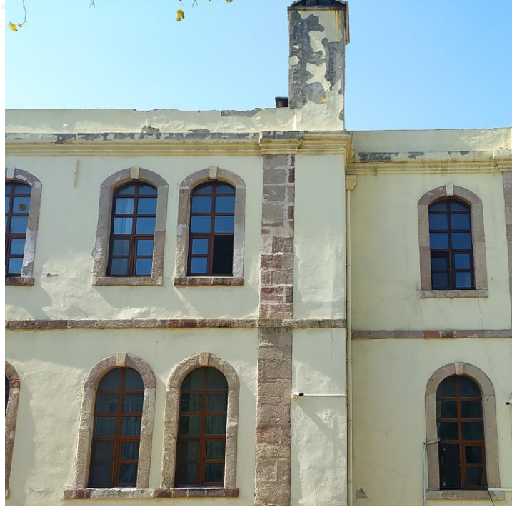
Resim 3.5.12. Bacadaki ve saçak silmelerindeki sıva dökülmeleri, 2022
