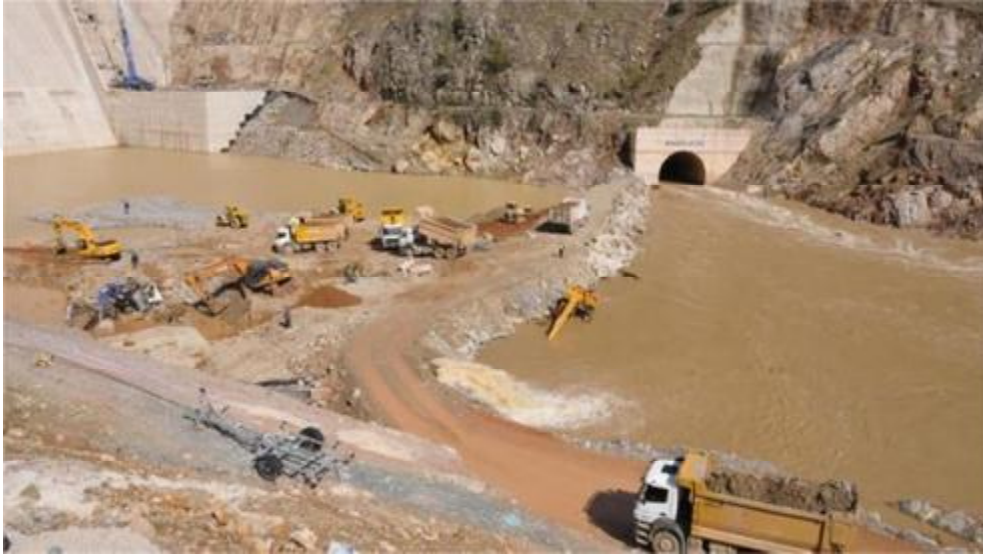
Şekil 1.9. Gökdere baraj kapağının patlaması-2012 ( http://www.hurriyet.com.tr/ )
