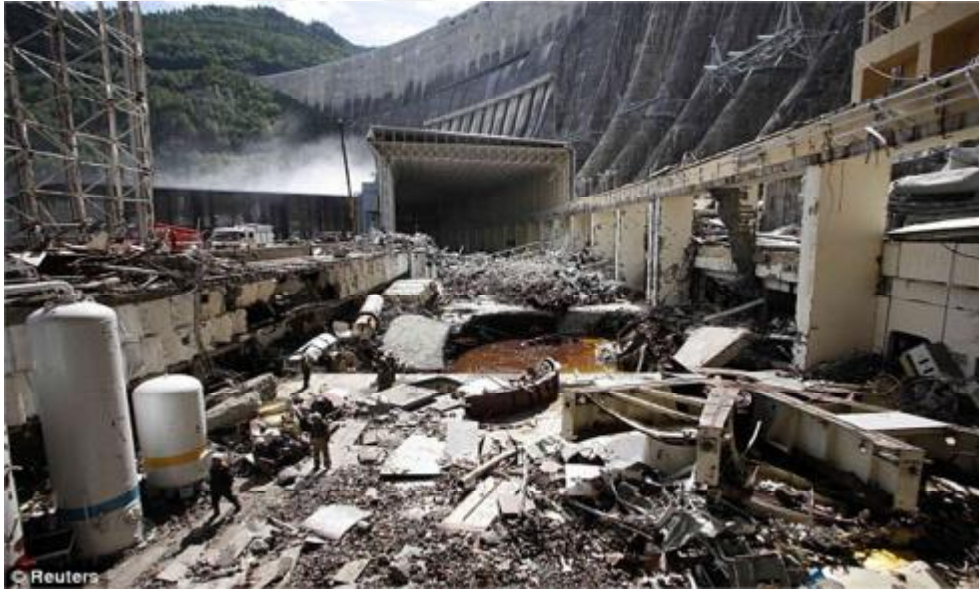
Şekil 1.10. Sayano/Shushenskaya Barajı'nın yıkılması-2009 ( http://www.dailymail.co.uk/ )
