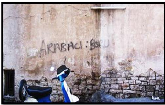
Resim 4.142. Güneydoğu cephesinde bozulmalar [Gül, 2012]
