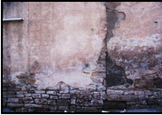
Resim 4.132. Dökülme ve çatlama [Gül, 2012]
