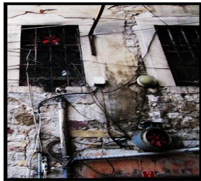
Resim 4.146. Cephedeki tesisat kabloları [Gül, 2012]
