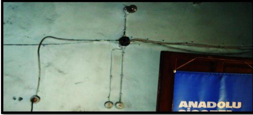
Resim 7.4. 1-04 mekânı elektrik tesisatı
