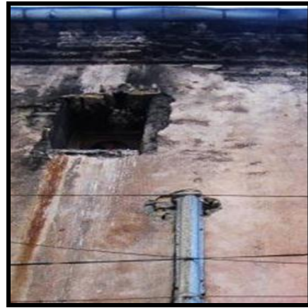
Resim 4.136. Saçaklar ve yağmur iniş borularında bozulmalar [Gül, 2012]
