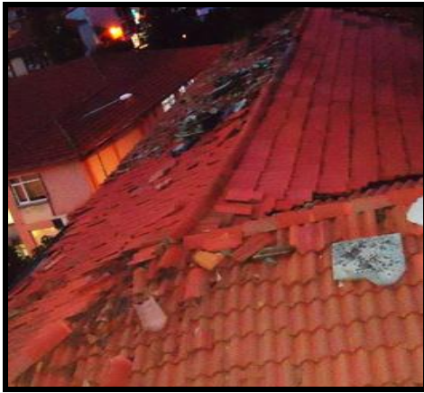
Resim 4.135. Çatıda çökme ve açılmalar [Gül, 2012]
