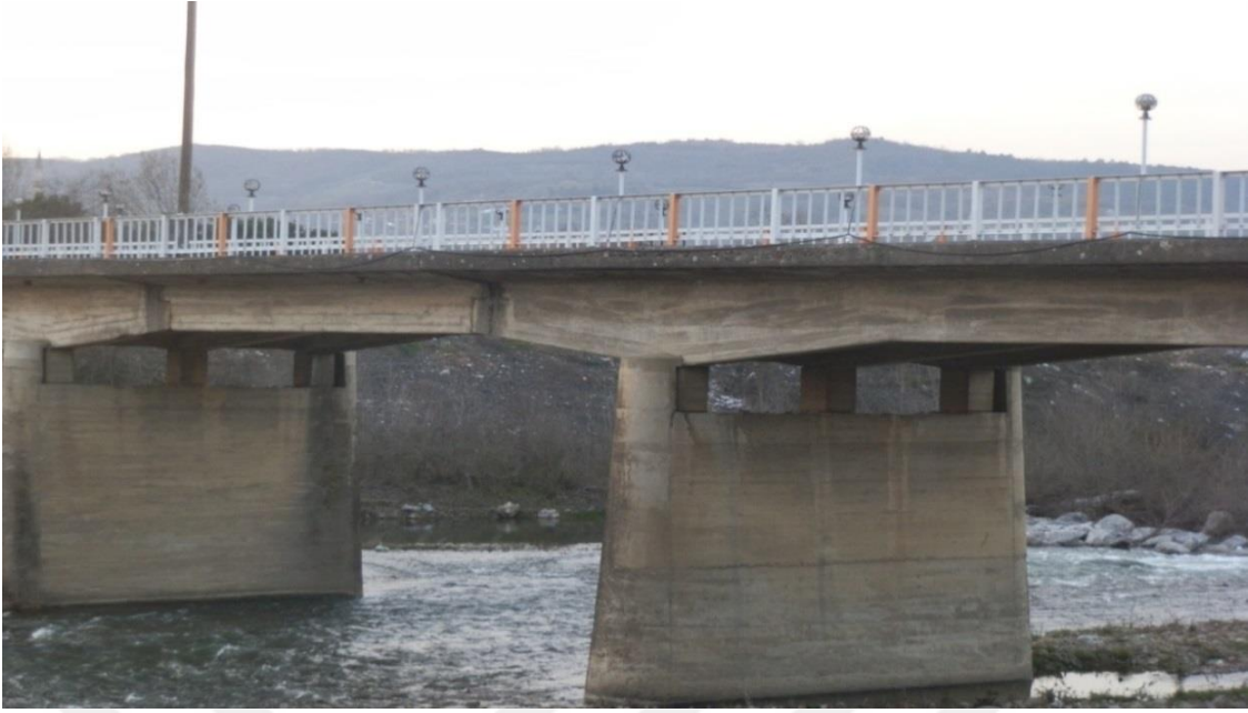
Şekil 22: Mevcut Haliyle Risk Taşıyan Kozcağız Köprüsü
