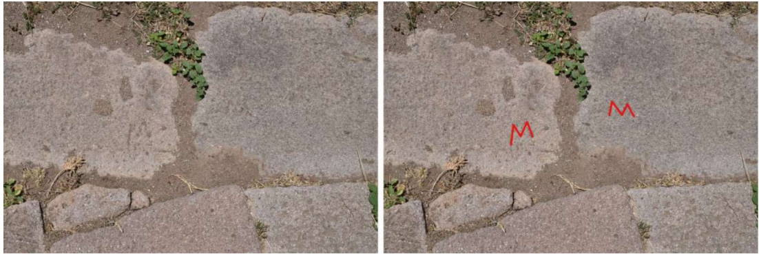
Şekil 3.4 Bergama'da Trajan Tapınağı kutsal alanında bulunan exedra yapısında görülen, çevresel koşullar nedeniyle aşınmaya uğramış birleşim izlerinin günümüzdeki durumu (Kişisel arşiv, 2017)
