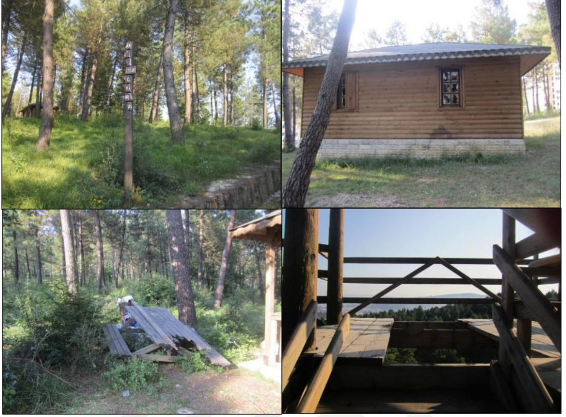
Şekil 8: Bartın Kent Ormanı'ndaki tahrip edilmiş tesisler.
