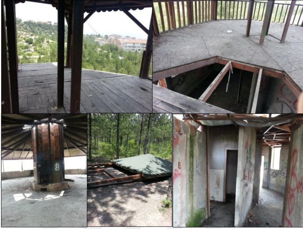
Şekil 24: Karabük Kent Ormanı'nda tesislerdeki hasarlar.
