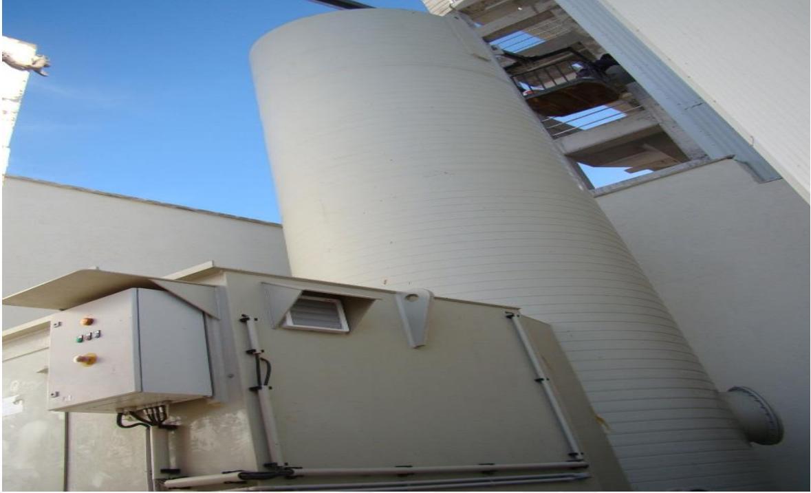
Şekil 5.11. Gaz kükürtsüzleştirme ünitesi
