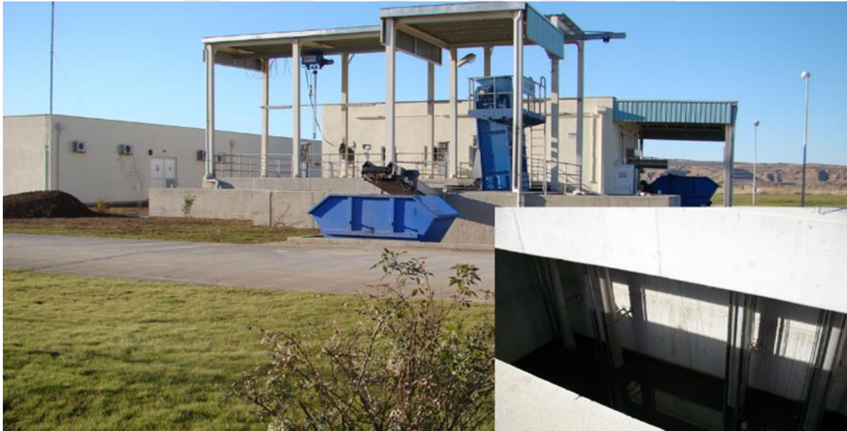
Şekil 5.3.Giriş pompa istasyonu
