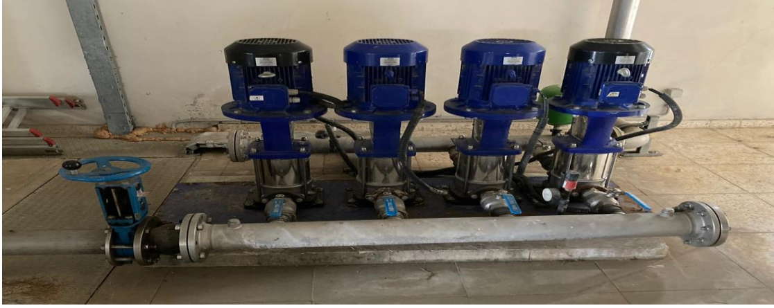
Şekil 5.9. Temiz su pompaları
