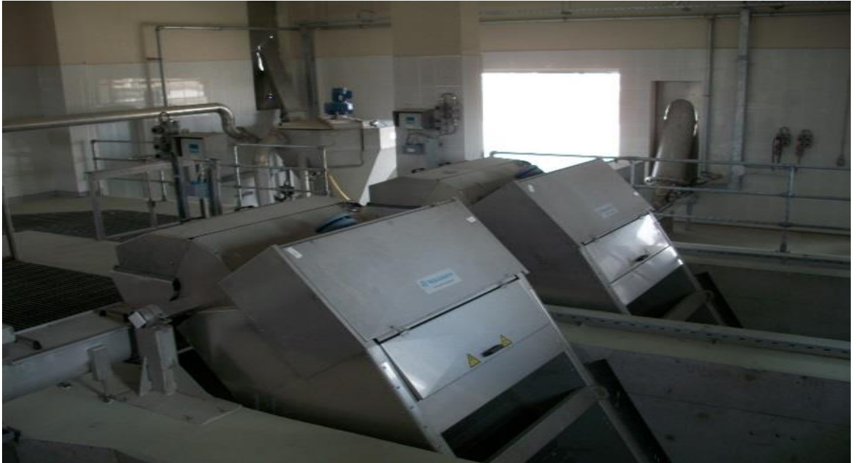
Şekil 5.5. İnce ızgara ünitesi
