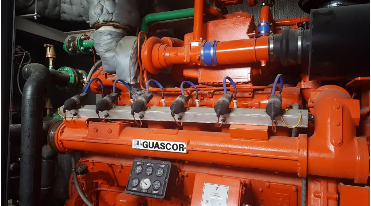
Şekil 5.15. GUASCOR FGLD 360 tipinde biyogaz yakıtlı gaz motoru
