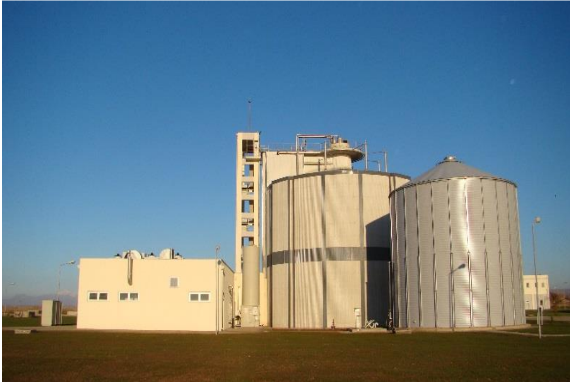
Şekil 5.10. Çamur çürütücü tank
