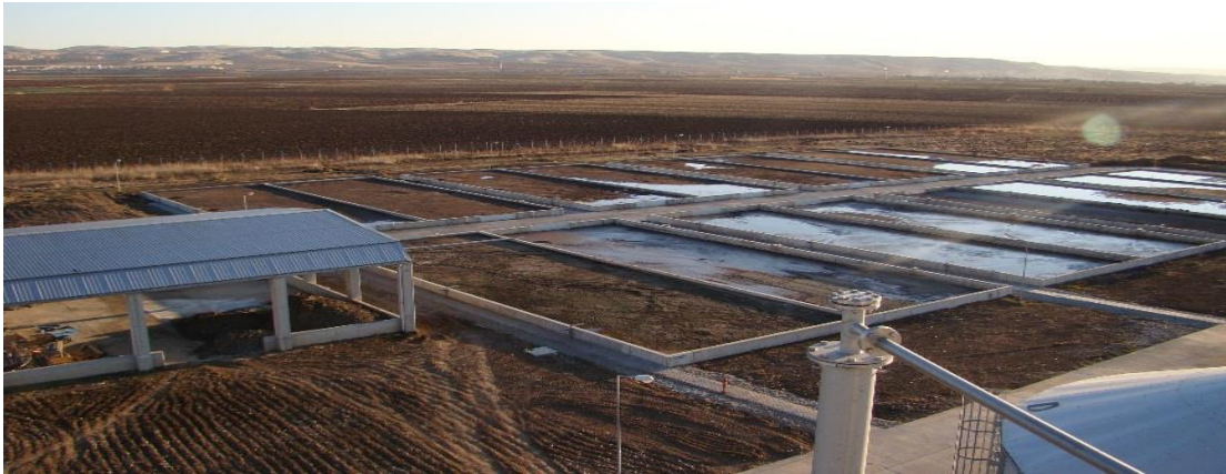
Şekil 5.12. Çürütülmüş çamur kurutma yatakları
