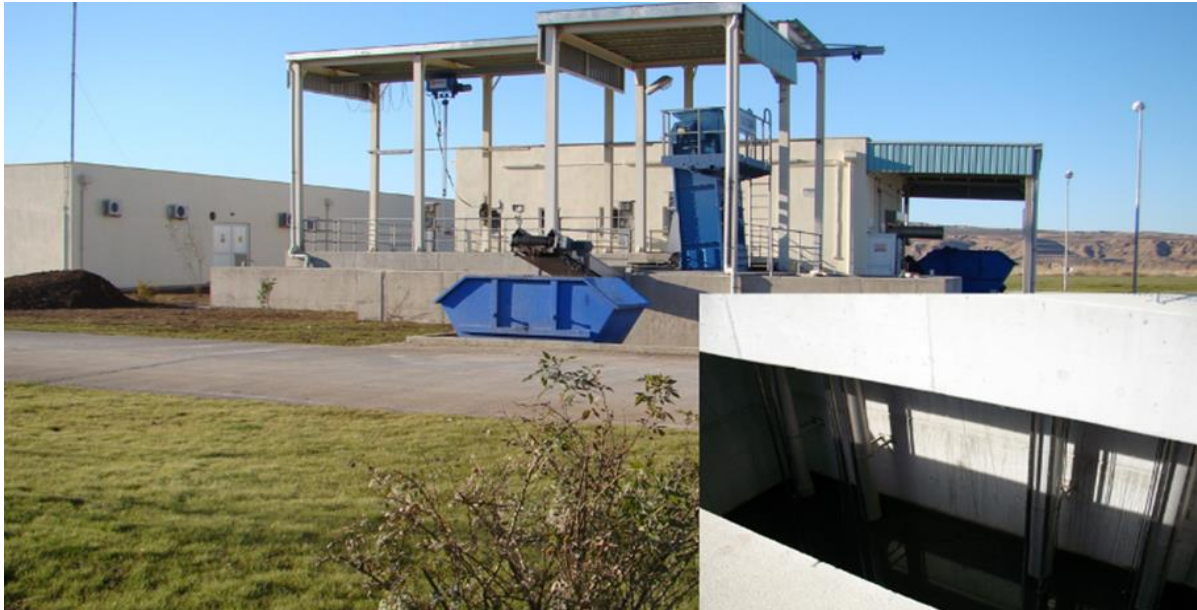
Şekil 5.3. Giriş pompa istasyonu
