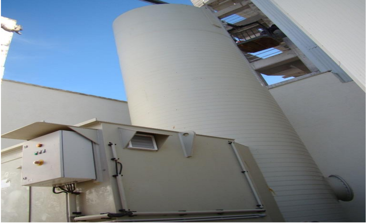
Şekil 5.11. Gaz kükürtsüzleştirme ünitesi
