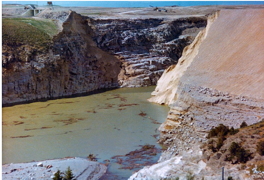
Şekil 2.7 Teton Barajında yıkılma sonrası oluşan gedik [14]
