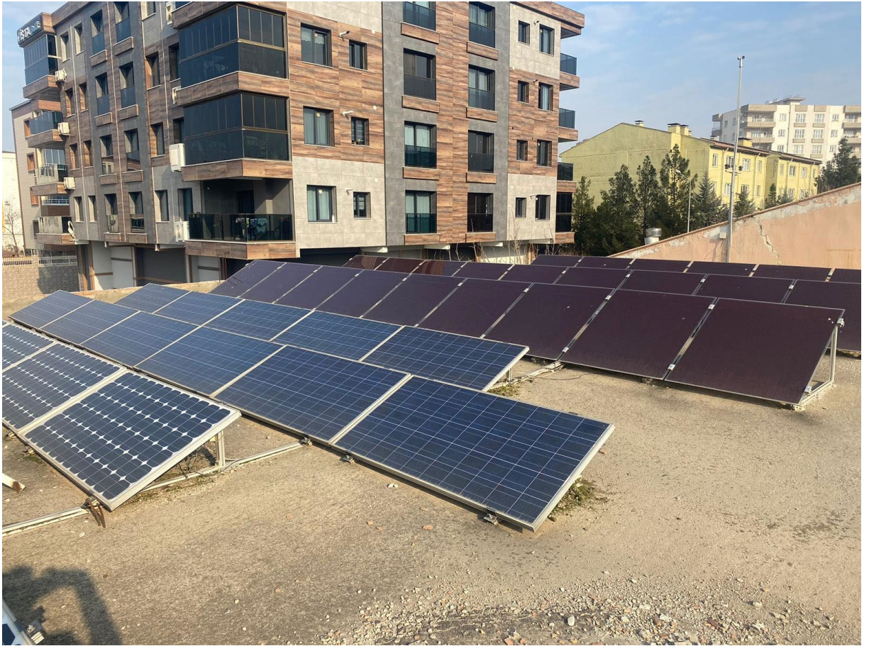
Şekil 3.6. Batman Gültepe Simya Koleji çatısındaki PV sistemimiz
