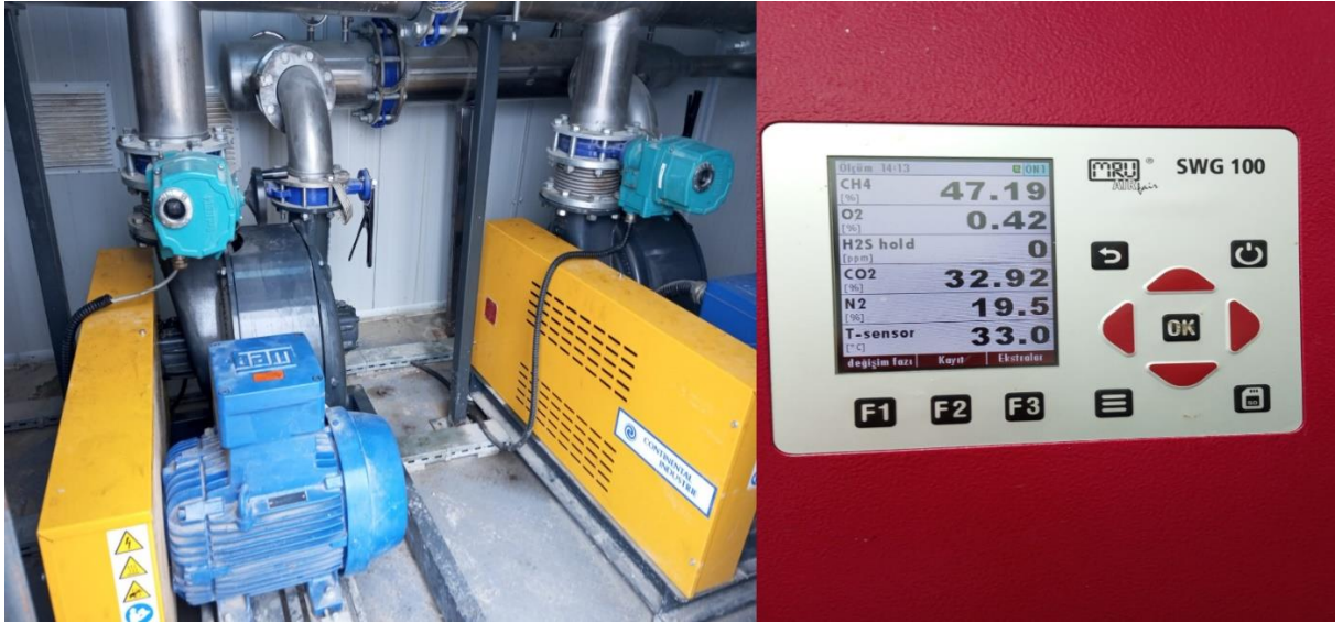
Şekil 9: BAY-GÜ-KAB Tesisinde Bulunan Booster ve Gaz Oran Ölçümü
